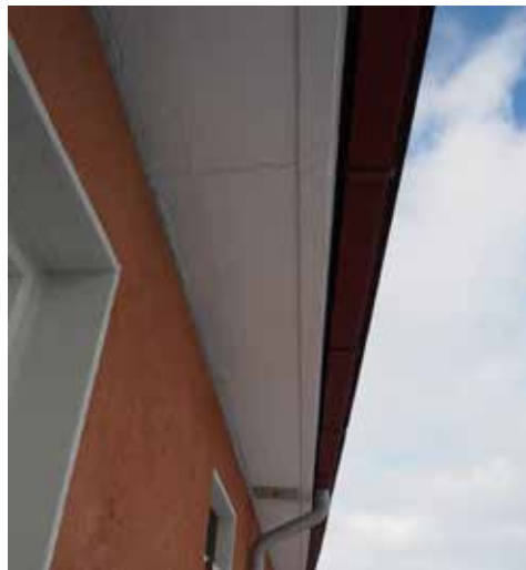
Betoniräystä, as.oy Teiskontie 25
