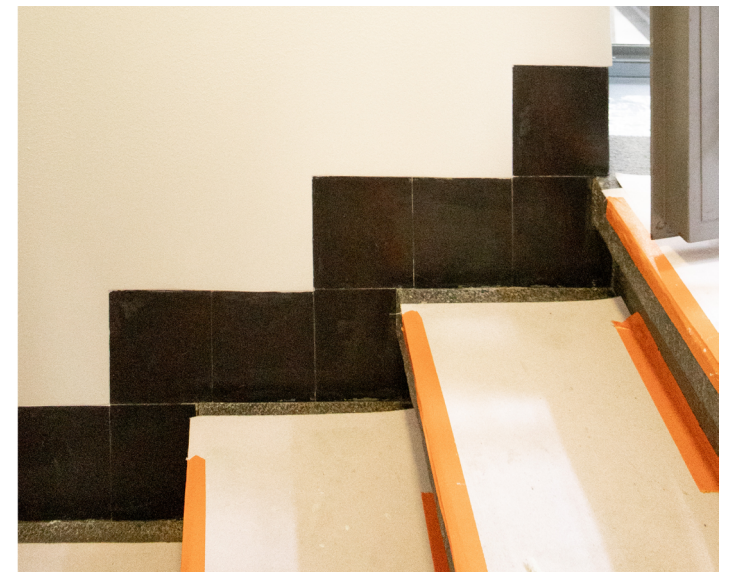
Vuonna 2025 toteutetuissa sisäilmakorjauksissa kantavien seinien alapohjaliittymiä tiivistettiin. Seinäpinnan alta löytyi sattumalta 1930-luvulla keskuskäymälän sisääkäynnille rakennettuja mustia sementtilaattoja. Laatat otettiin korjauksissa esille graniittiportaatan kohdalta.
