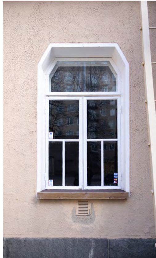
Keittiön ikkuna on alkuperäinen, mutta varsinaista vesipeltiä ei ikkunan alaosassa enää ole.
