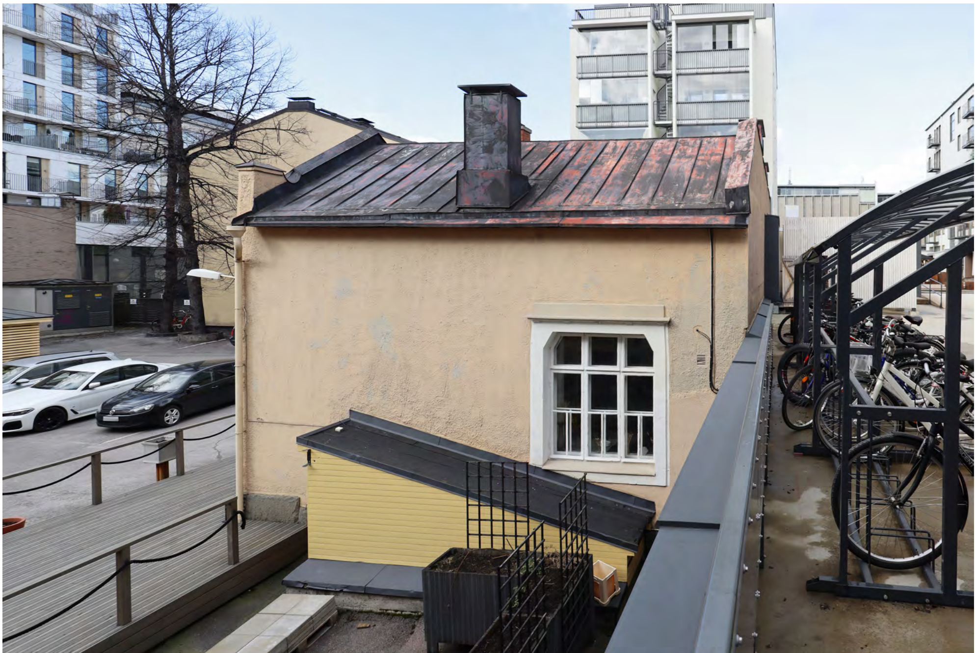
Piharakennuksen eteläjulkisivu. Kellariin johtavalle ulkoportaalle on rakennettu jälkeinpäin sadekatos joka viistää alkuperäisen ikkunan alareunaa.
