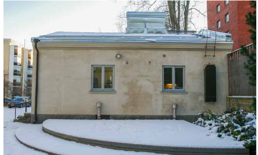
Piharakennus kuvattuna pohjoisesta. Rakennuksen viereen on rakennettu lava tai terassi ja kellarikerroksen ikkuna ummistettu. Samoin huoltotikkaaseen on lisätty kupu, joka estää kiipeilyn.
