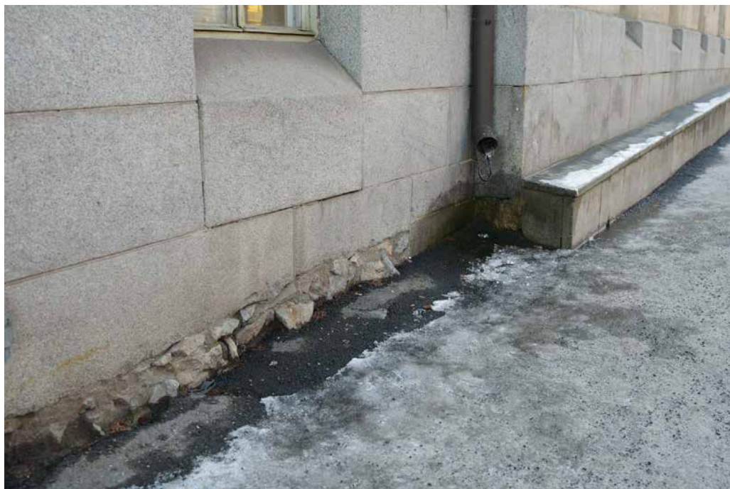
Katutason laskemisen vuoksi rakennuksen perustukset ovat vuoden 1930 osan puolelta hiukan näkyvisiä. 1902 rakennetun osan sokkeliin on rakennettu ulkoneva lisäsokkeli, joka kulkee jotakuinkin alkupeärisen maanpinnan korkeudella.
