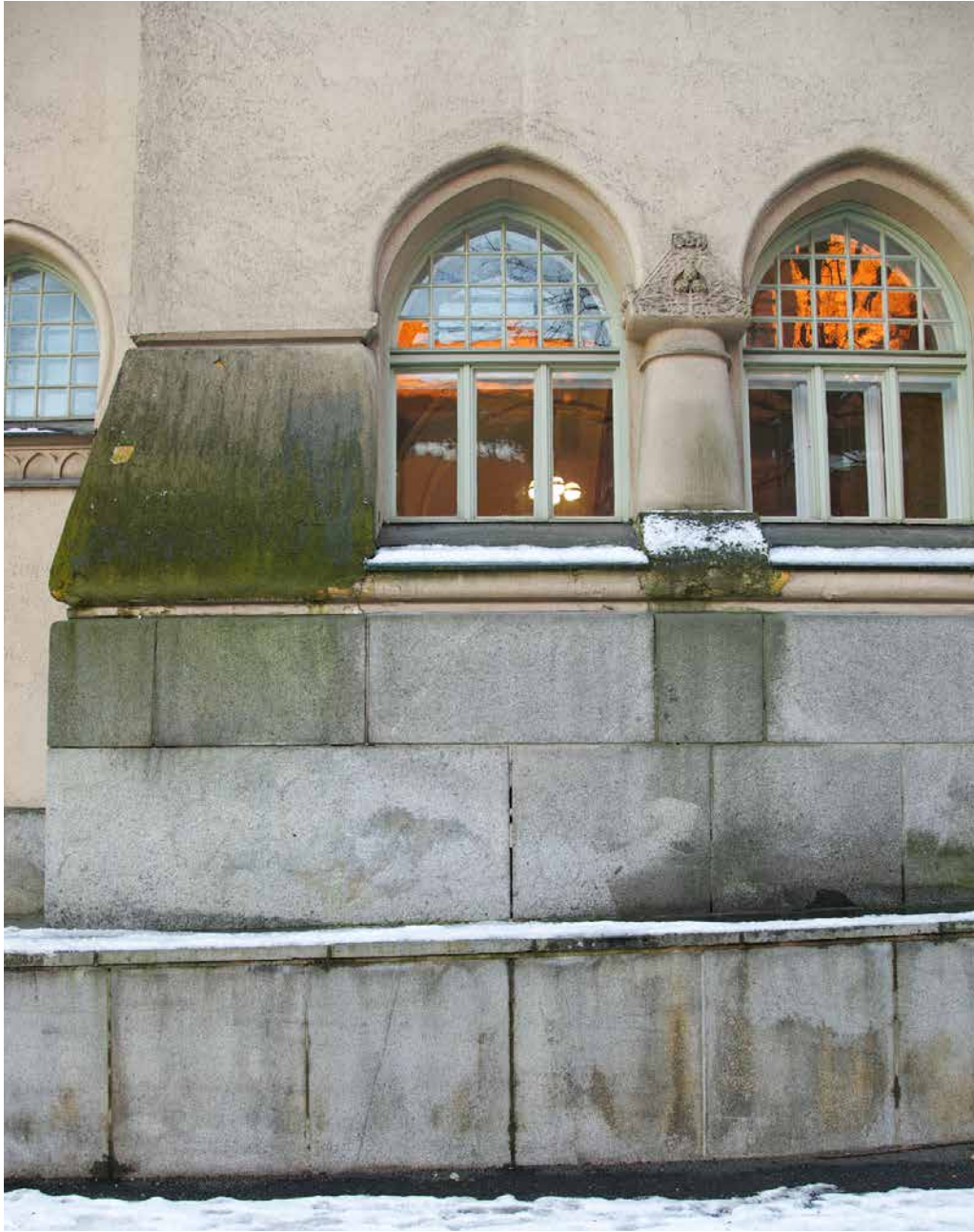
Kellotornin alaosassa on samanlaisia koristeaiheita kuin pääsisäänkäynnissä. Julkisivu levenee kohti kivijalkaa ja on kosteusrasituksen vuoksi alkanut leväntymään. Pintarappausta lukuun ottamatta julkisivun koristeet ja muoto ovat säilyneet hyvin.
