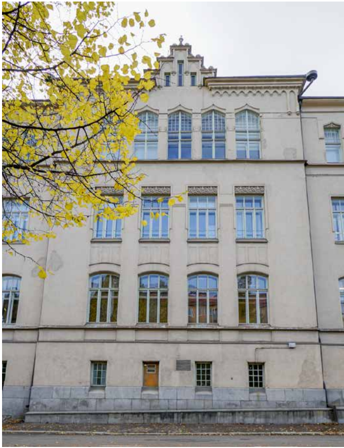
Hämeenpuiston puolella yksi kellarin ikkunoista on ummistettu.
