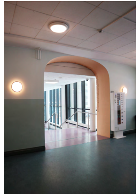
Vanhan osan liittyminen yhdyskäytävään ei ole alakattoratkaisun osalta saumaton.
