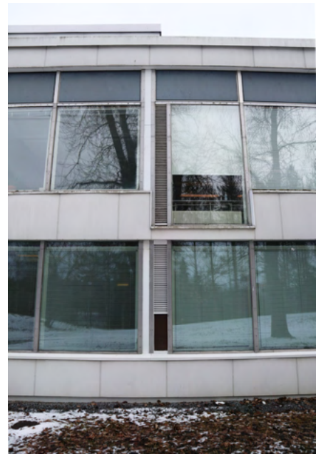
Alkuperäistä julkisivua on mineriittilevyjen osalta korjattu. Suuret ikkunat tuovat valoa matalahkoihin tiloihin.
