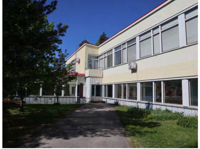
1960-luvun laajennusosan alemmassa kerroksessa on sivukäytävät, jotka saavat runsaasti valoa. Ylemmässä kerroksessa on luokkahuoneita.
