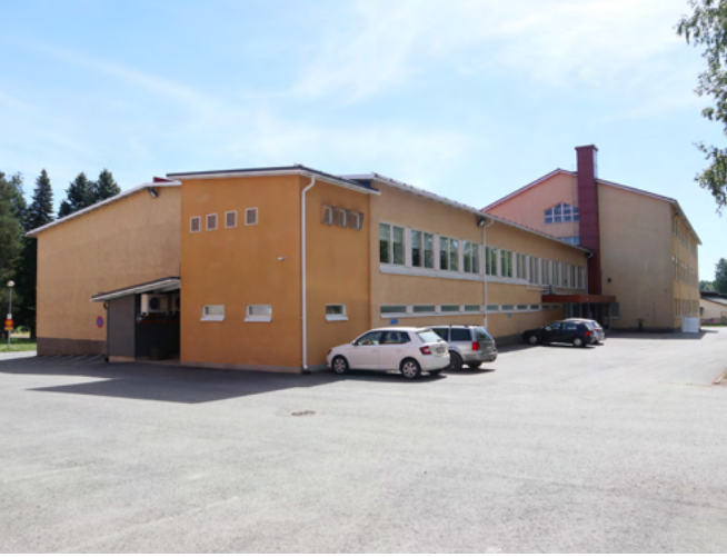
Yhtenäiskoulun ja lukion rakennuskokonaisuus kuvattuna pohjoispuolelta. Oikealla näkyy luokkahuonesiipi tiillisine piip-puineen, vasemmalla 1960-luvun laajennusosaa. Pohjoispuo- lelle on sijoitettu edustalla näkyvä ilmanvaihtokonehuone.
