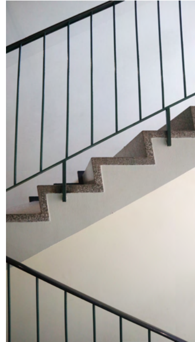
Tammerkosken koulutalon portaiden askelmat ovat mosaiikkibetonia.
