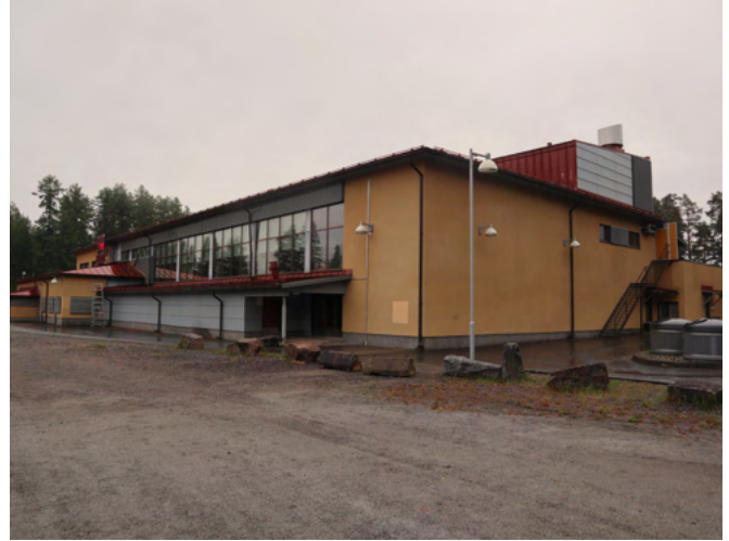
Liikuntasali rakennettiin vuonna 1969. Sen ilme on muuttunut peruskorjauksessa 2010-luvun alussa. Myös ilmanvaihtokonehuone katolla on muuttanut alkuperäistä arkkitehtuuria.
