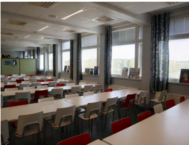
Ruokala sijoittuu osaksi avointa aulaa. Tilassa näkyvät alkupe- räiset betonipilarit ja -palkit.
