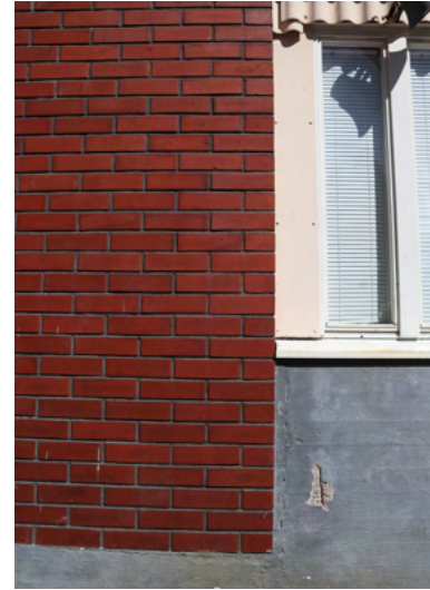
Juupajoen alakoulurakennuksen julkisivumateriaaleina on käytetty betonivalun ja tiilen lisäksi aaltopeltiä ja mineriittilevyä.
