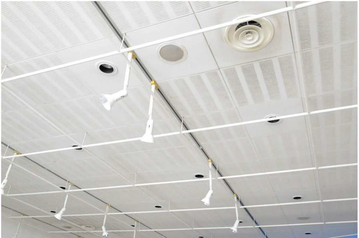
Kohdevalaistusjärjestelmä ja ripustuskiskot, alakatto
