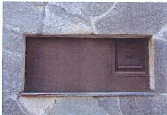
Pankin tallelokeron luukku idän puoleisessa sokkelissa.
