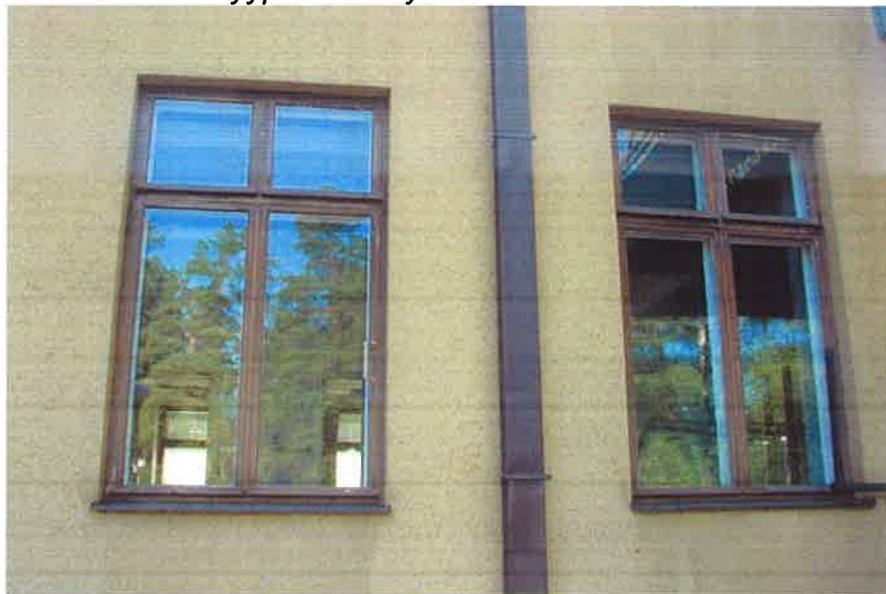
Kuva. B-siiven pohjoispuolella on jäljellä alkuperäiset ikkunat.
