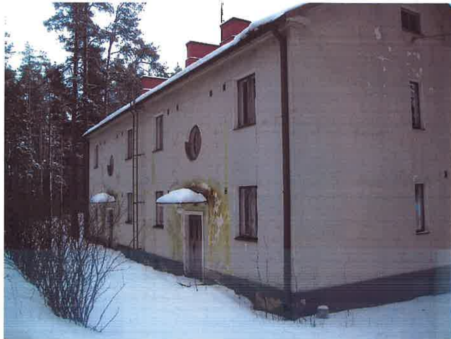
Kuva. Lukkola on ollut pitkään poissa käytöstä ilman lämmitystä.
