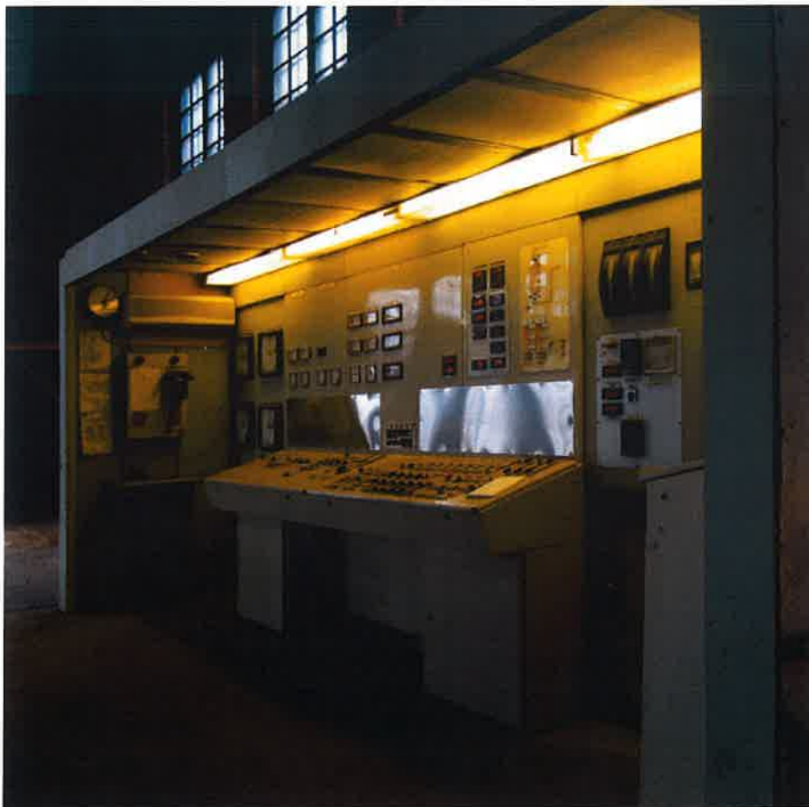
Yllä voimalaitoksen kattila, vieressä valvomo.
