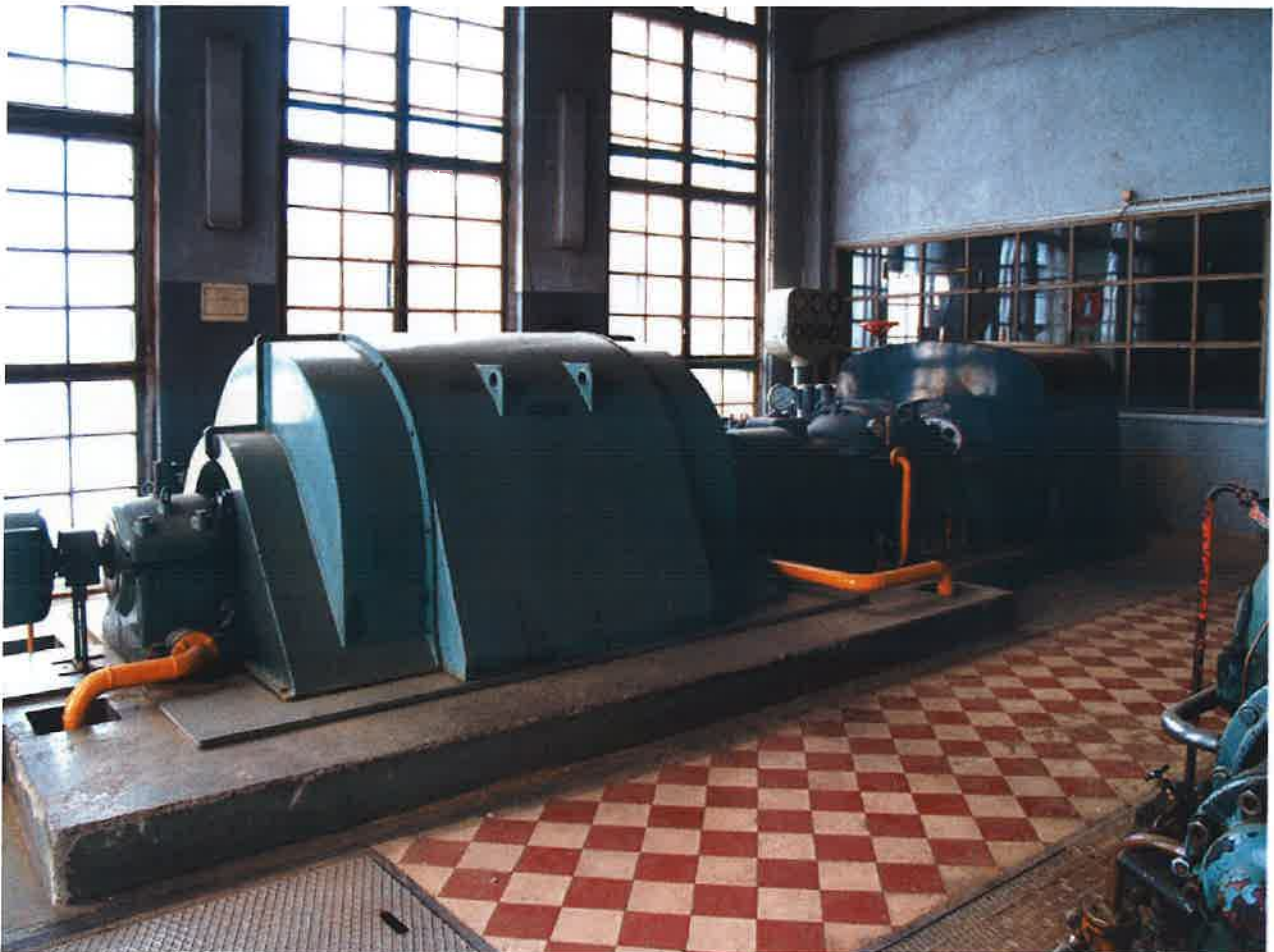
AEG Kanis vastapaineturbiini saatiin höyryvoimalaitokseen vuosien 1961-62 laajennuksen yhteydessä.
