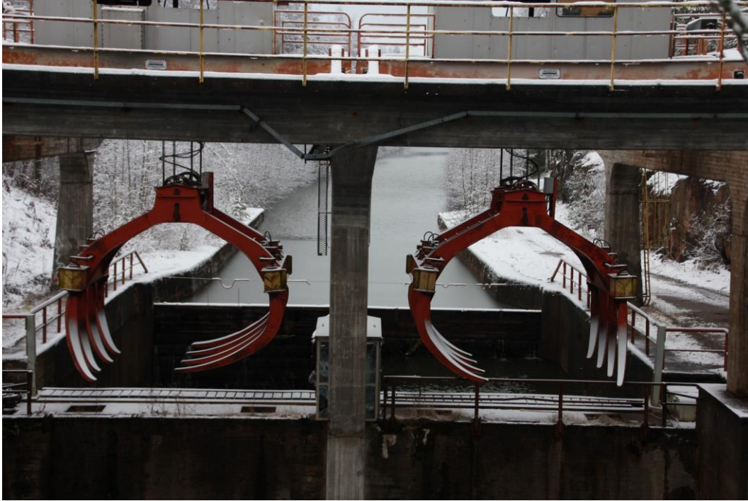
Kuva 21. Kimolan kanavan nippunosturit jäivät tarpeettomiksi uiton loppumisen myötä. Nosturit ja muut uittoon liittyvät rakenteet purettiin, kun kanava muutettiin venekanavaksi 2018–2020.
