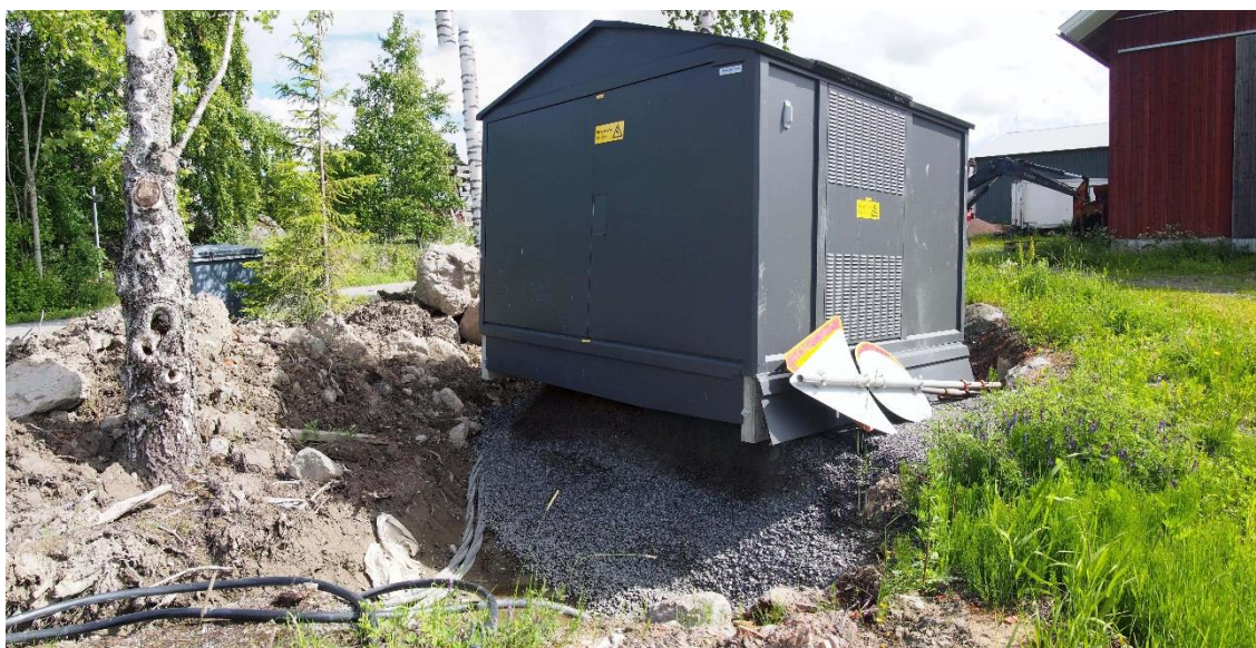
Kuva 23. Jo asennettu muuntamo Uuramontien varressa, Viekkalantien länsipuolella. Tätä kohtaa ei ole määritelty valvottavaksi Pirkanmaan maakuntamuseon lausunnossa 123/2016. Kuvattu lännestä. (Kuva: Sastamala Karkunkylä koekaivaus 2017:17)
