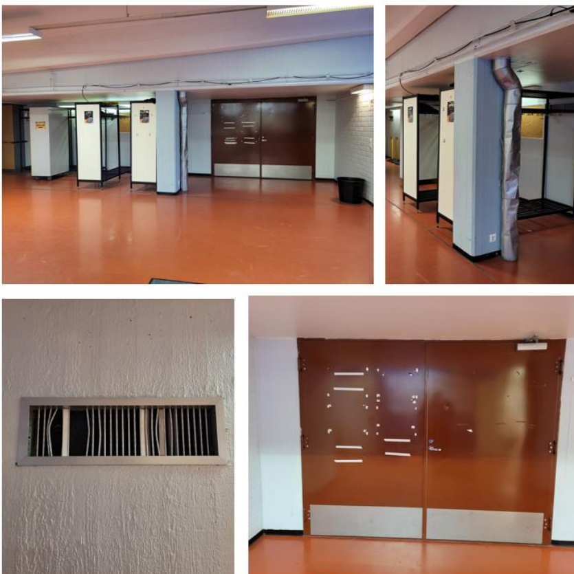
Kuva 19. Sisäntuloaulan katsomoon vievät alumiiniovet ovat maalattu ruskeaksi. Aulassa on melko paljon näkyvillä olevaa talotekniikkaa. Rappautumista on näkyvissä laajalti myös sisäntuloaulassa.
