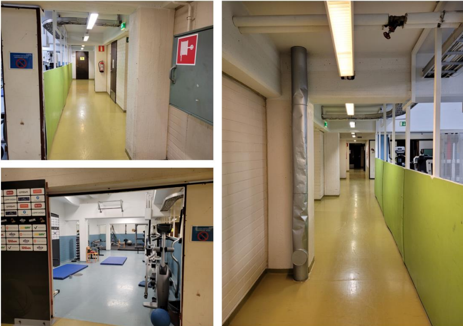
Kuva 28. Palloiluhallin kuntosalin ja sen yhteydessä olevien tilojen lattiat ovat värikkäitä vinyylimattoja. Tiiliseinät ja betonipilarit on maalattu pääosin valkoiseksi.
