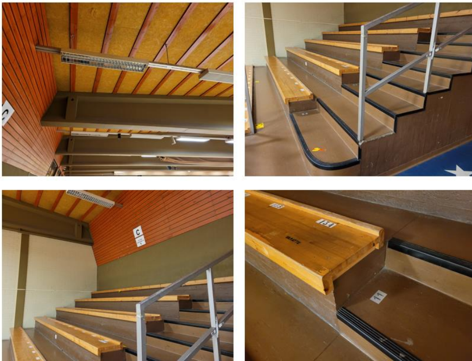
Kuva 27. Hallin katto on verhoiltu lastulevyillä. Kattoa kannattelee suuret, ruskeaksi maalatut teräksiset palkit. Katsomon takaosa on verhoiltu laudoilla. Katsomon kaiteet ovat harmaaksi maalattua terästä.
