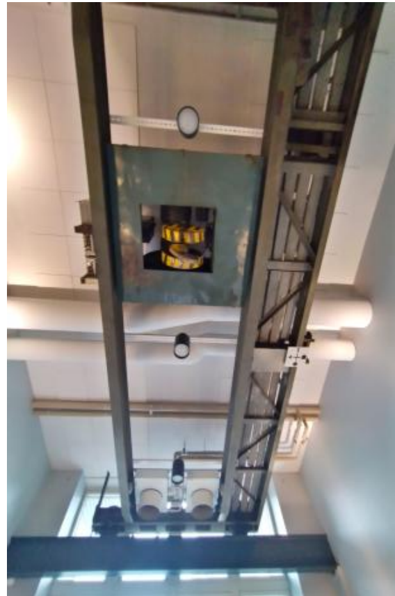
Kuva 64 1. kerroksen aulan hallinosturi
