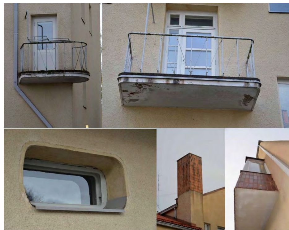
Kuva 23 Julkisivujen alkuperäisiä detaljeja, ylhäällä pihapuolen parvekkeita, alhaalla putkan ikkuna, pannuhuoneen piippu sekä postisalin erkkeri ja kulman pyöristys.
