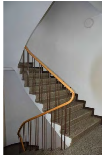
Kuva 14, postin pääportaан viereen, keskusaukion puolelle sijoittuvassa porrashuoneessa ovat säilyneet mosaiikkibetonista tehdyt portaат kaiteineen.
