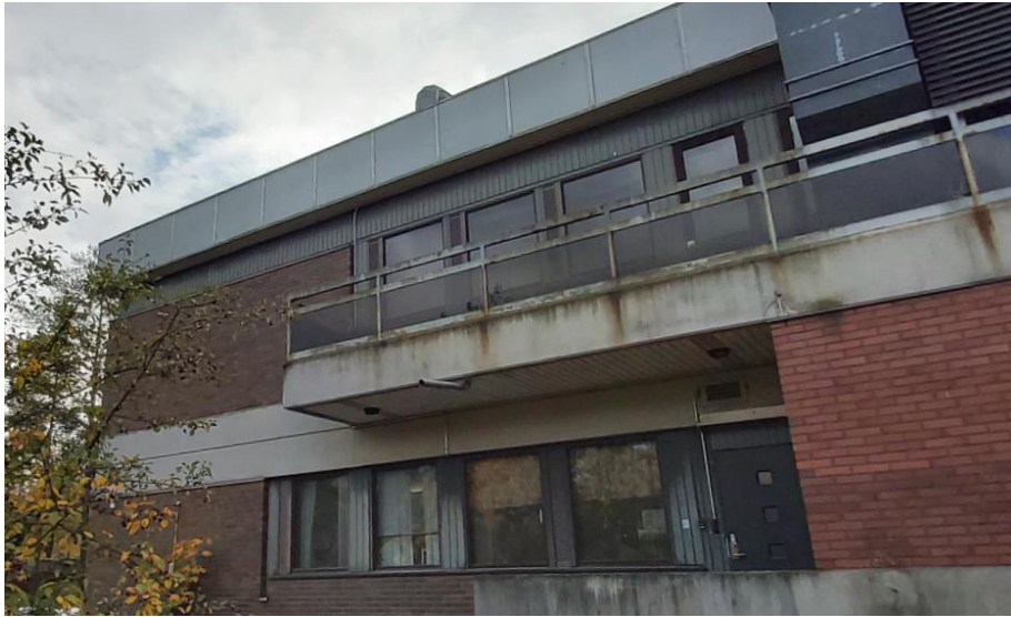
Pohjoisen julkisivun alkuperäisenä säilynyttä parvekettä, johon on yhteys tilaussaunaosaston toisesta pukuhuoneesta. Alkuperäisyyttä rikkoo IV-koneiden saneerauksen yhteydessä aiheutuneet julkisivumuutokset, jotka kuvan oikeassa reunassa katkaisevat parvekkeen nauhamaisuuden. Parveke on käyttökiellossa.
