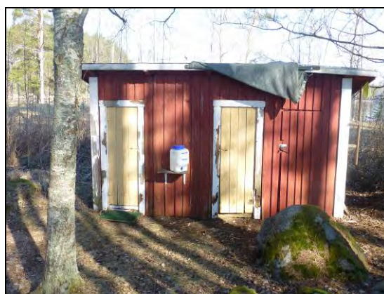
Nokkapirtin huonokuntoinen ulkovarasto.
