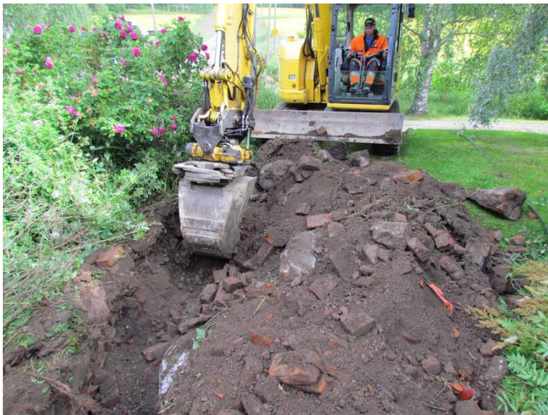
Kuva 4. Kaivuri kaivaa kaapeliuraa omakotitalon pihamaalla. Kaivannossa havaittu maannos oli sekoittunutta ja sisälsi todennäköisesti vanhan navetan purkujätettä. (Kuva: Nokia Sarkola 2016:3)
