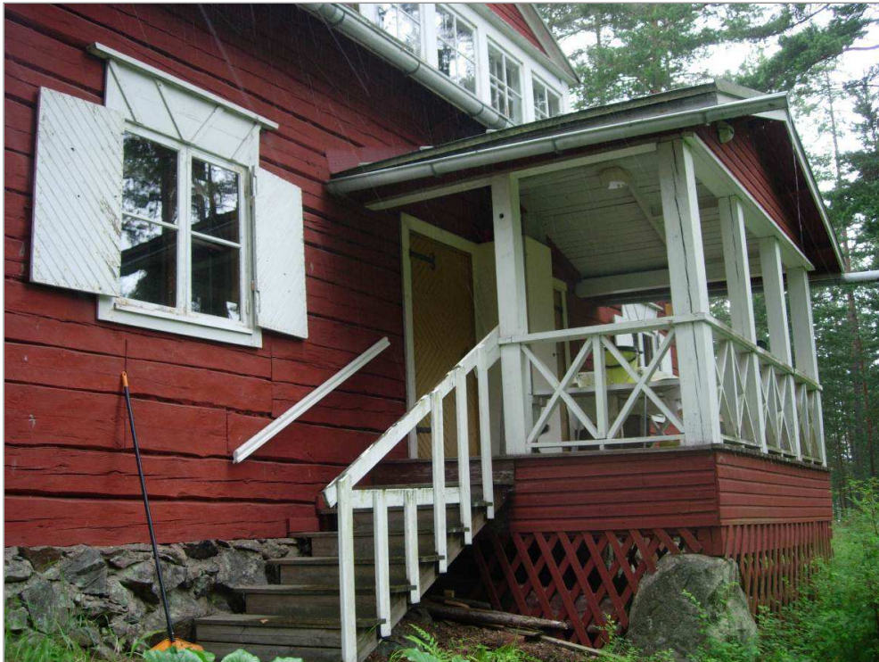
Kuva 18. Rakennuksen itäinen, metsänpuoleinen avokuisti. Alunperin portaat ovat kulkeneet kivistin itäsvuolta kohtisuoraan pois talosta. Portaiden paikka on muutettu todennäköisesti jo 1930-luvulla Anton Selinin johdolla. Kuvattu kaakosta.
