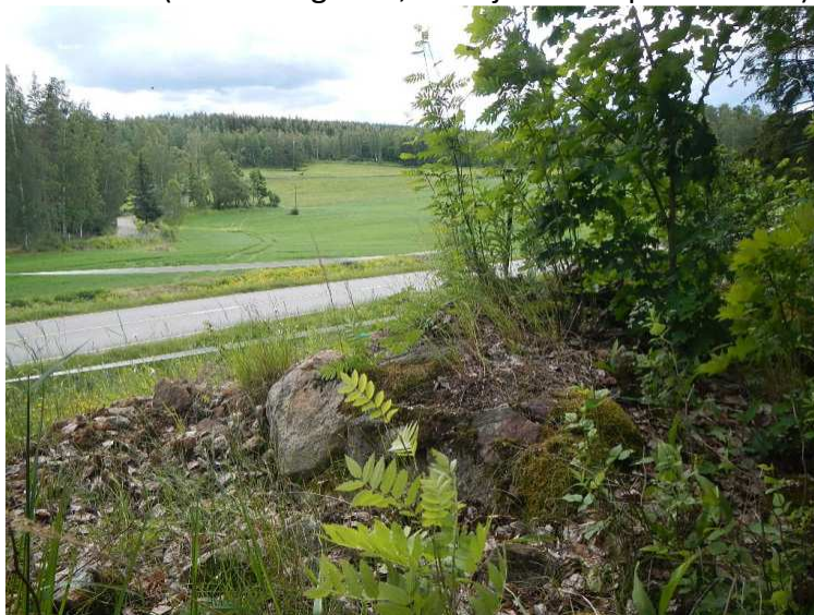
Kuva 11. Puoliksi tuhoutunut raunio kuvattuna pohjoisesta. Raunion tuhoutumattomasta osasta suurin osa sijaitsee kuvan oikeassa reunassa olevien pensaiden/pienien puiden varjossa. (Kuva: Kangasala, Huutijärvi – Pispala 2014: 5)
