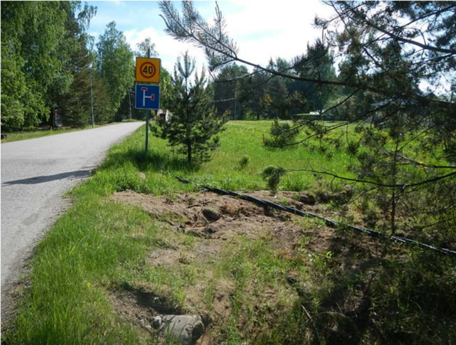
Kuva 5. Rikkoutunutta pintamaata Ponsantien ja Laiska-Jaakontien risteyksen itäpuolella, noin 10 m päässä risteyksestä. Kuvattu lännestä. (Kuva: Kangasala, Huutijärvi – Pispala 2014: 1)
