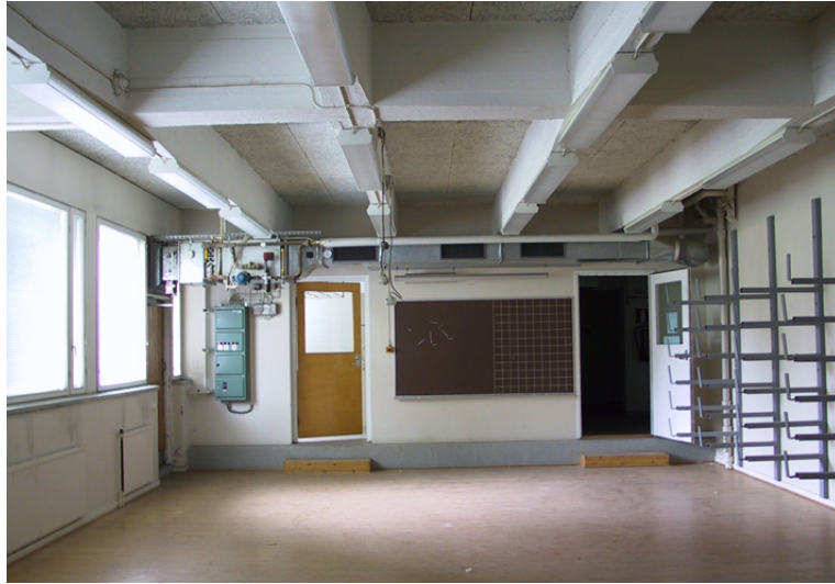
Kuva 4.11: Ensimmäisen kerroksen veistoluokan katossa kulkevat ilmastointiputket on asennettu palkiston alapuolelle.
