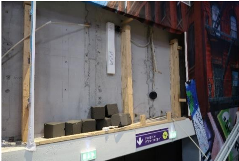
Kuva 26. Puupaneloinnit pääsalin seinistä on purettu ja seinät ovat betonipinnalla, jossa koolaukset ovat jäljellä.
