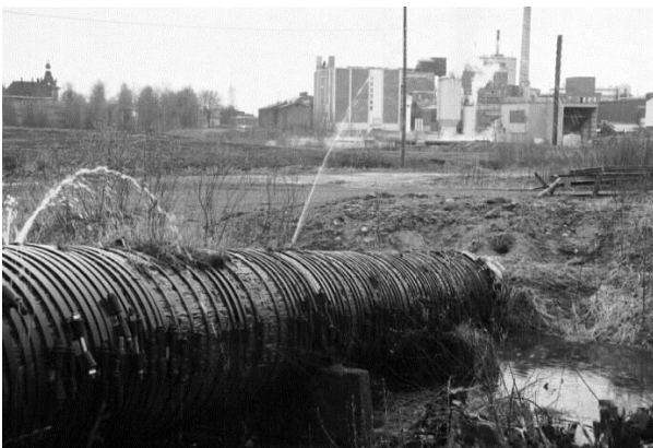
Moneen otteeseen paikatus vesiputken pää tehdasalueella vuonna 1999. KUVA Raija Grahn/Vapriikin kuva-arkisto
