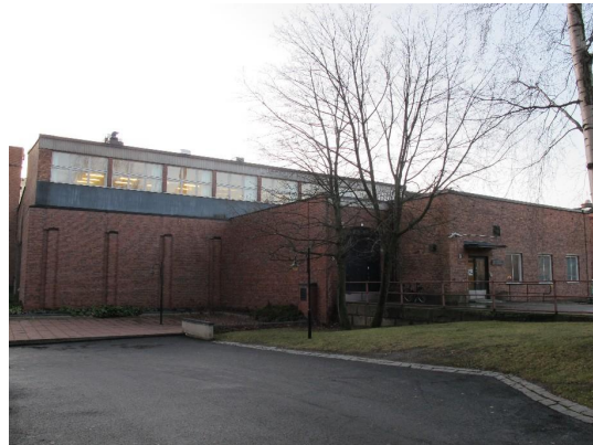
Etelähallin eteläpuolella on uusittu muurauspinta purettujen piharakennusten kohdalta. Yläkerroksen ikkunanauha on 1960-luvun teollisuusarkkitehtuuria.
