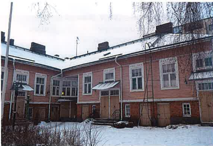
Pihajulkisivut. Väritys on tasapainoinen ja rakennusosat hyvin säilyneitä. Tiilirakenteinen osa rajaa sisäpihaa.
