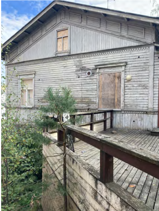
Vasemmalla: Rakennuksen itäpäätyyn on jälkeinpäin tehty tyyliin sopimaton terassi ilmeisesti myöhemmin rakennetun keittiön sisäänkäynnin yhteyteen.
