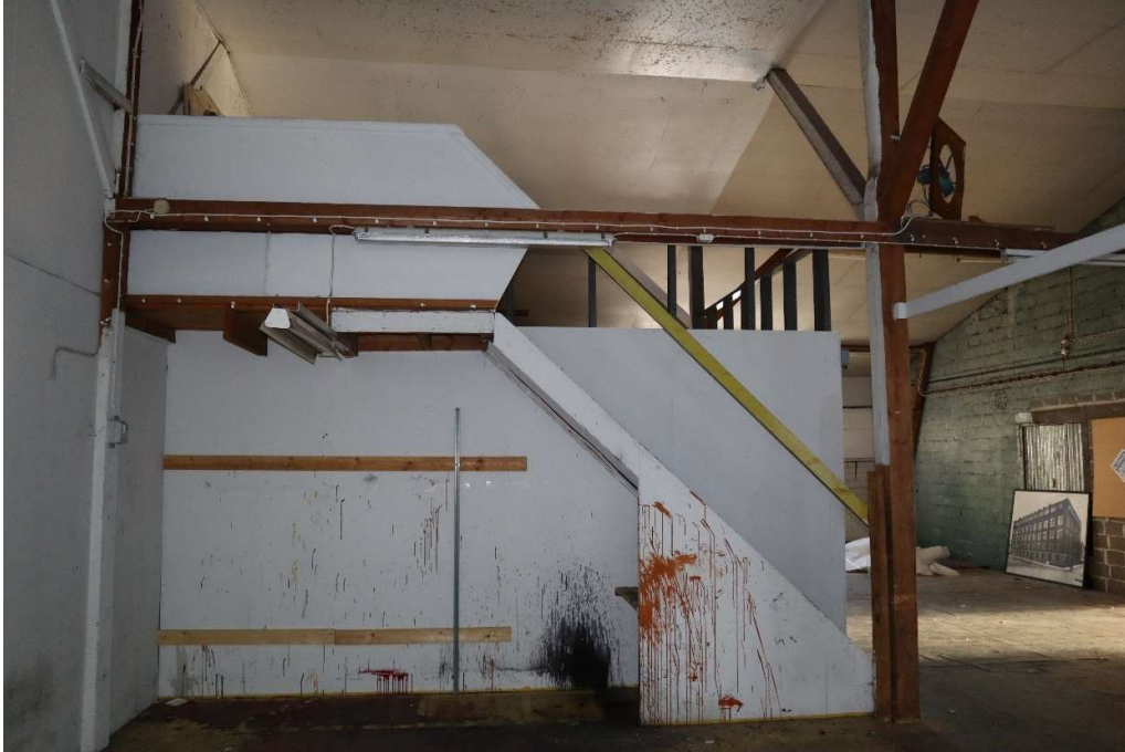
Kuva 16. Varastohallin maalinkäsittelypiste, pikkuvaraston lännen puoleinen seinä.
