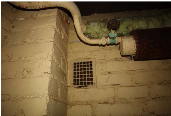
Kuva 38. Autotallin ilmastointiritilä ja patteri katonrajassa
