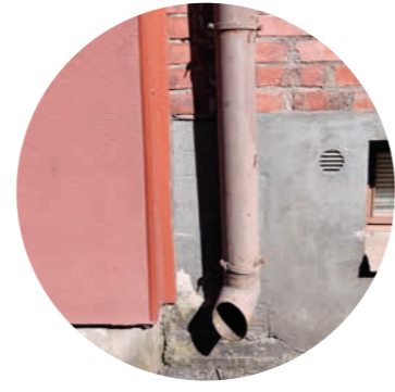
Julkisivuissa toistuvat vauriot: pinnoitettujen peltipintojen maalipinnan ja paikoin tiilipinnan laastin rapistuminen
