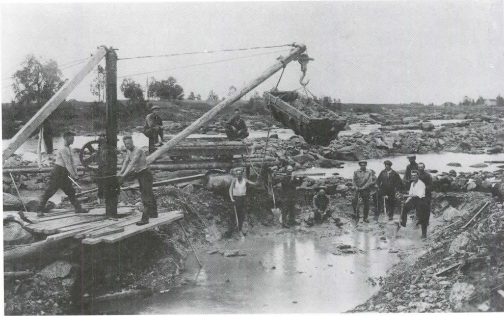
Historiallisia työkuvia Tyngän myllyn kokoel- mista: voimakanavaa kaivetaan vuonna 1916 ja ensimmäistä sahan raamia asennetaan paikalleen.
