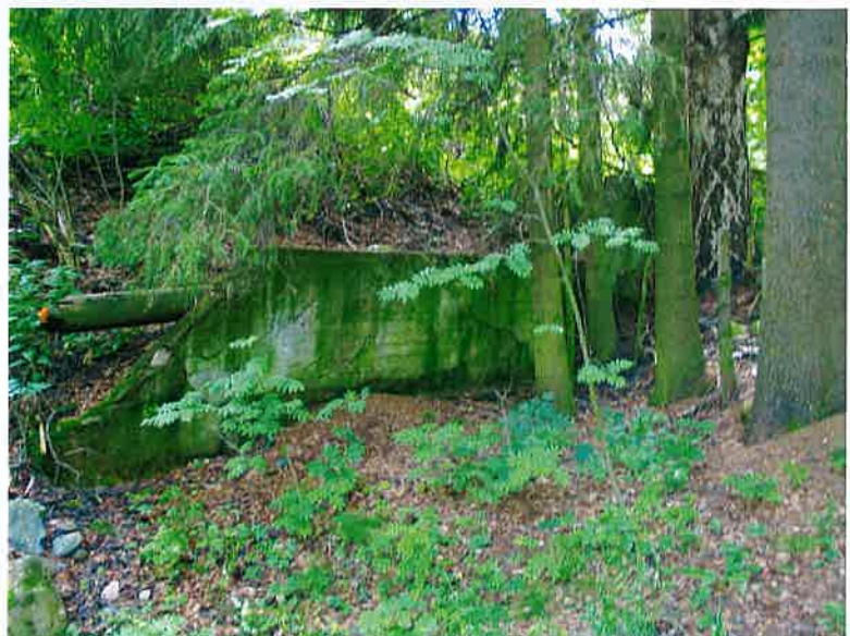
KUVA 31. Idän betonimuuri sortuneesta kohdasta. Kuva otettu pohjoisesta etelään. (Kuva Pauliina Siltanen)
