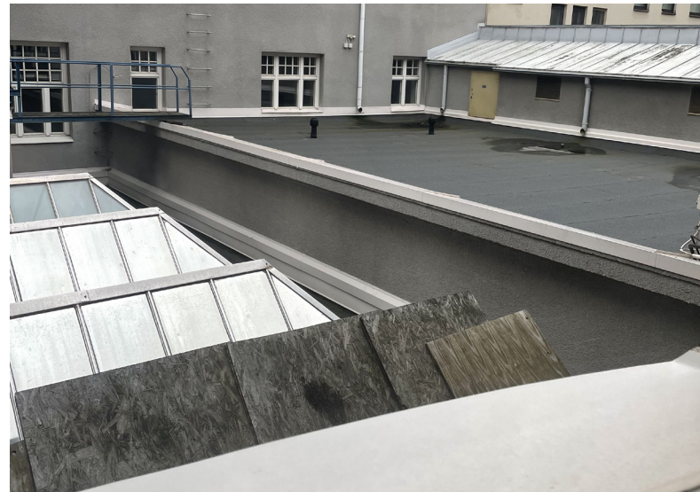
↑67 Kuvassa sisäpihan lasikate ja ilmeisesti suojauksia vesikaton luomikuorman putoamisen varalta. Kuvassa myös makasiiniosan kermitys ja kulkusilta katolle pihanportaan tuuletusparvekkeen kautta.
