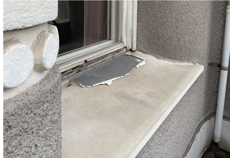
↑66 Kuvassa Hämeenkadun puoleisen parvekkeen ikkunan ja vesipellin kulumaa. Parvekkeen vedenpoisto ei näytä toimivan optimaalisesti.
