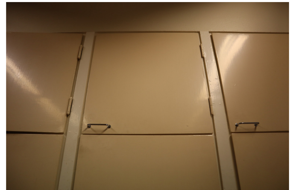
Itään aukeaviin ensimmäisen ja toisen kerroksen perheasuntoihin asennettiin 1960-luvun toimistomuutoksen yhteydessä lukolliset kiintokaapit.
