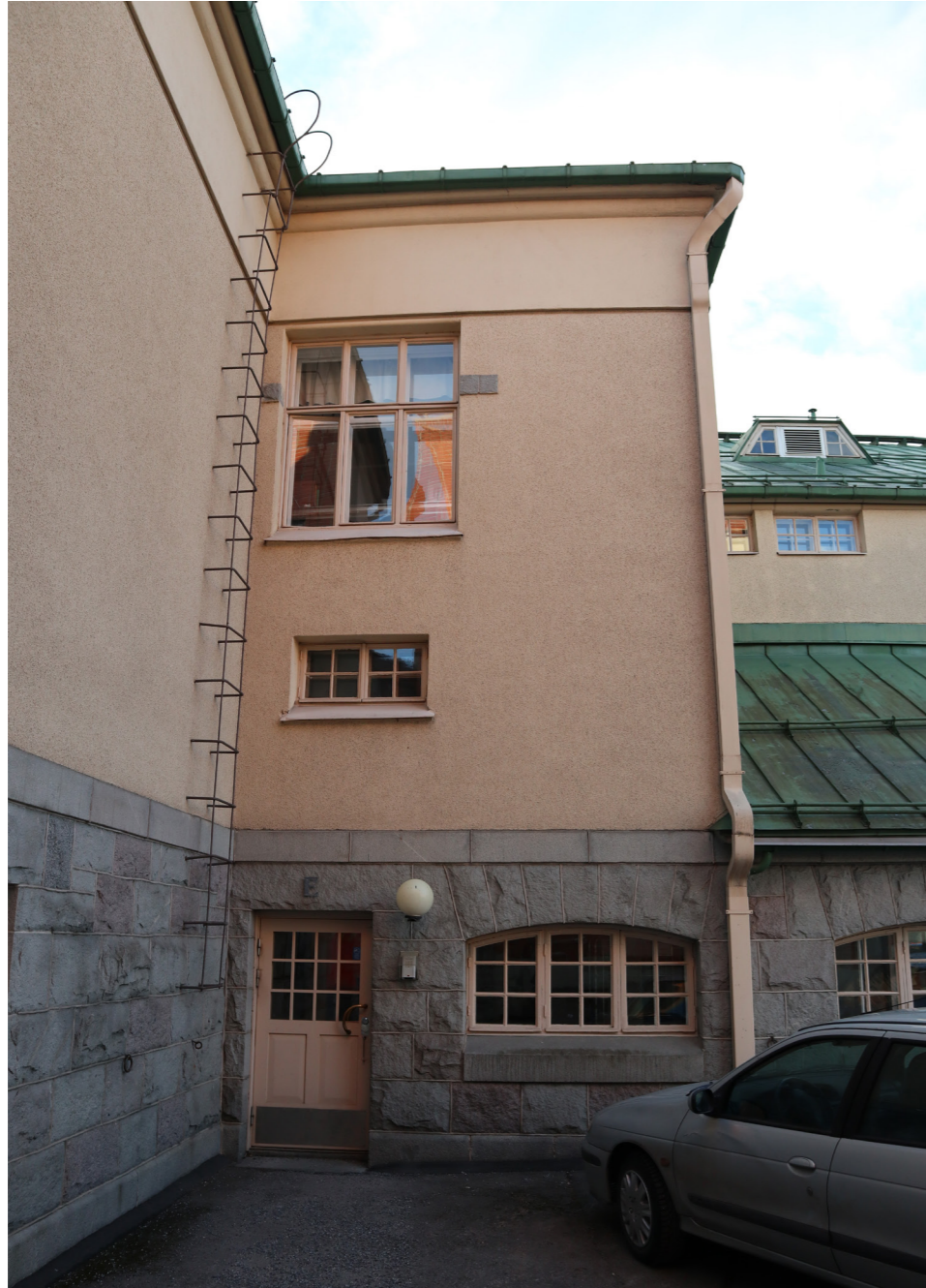
Rakennuksen ensimmäinen kerros on palomestarin asuntosiipeä lukuunottamatta verhoiltu kauttaaltaan puna- ja harmaagraniitilla. Kaikkien julkisivujen yleiskunto on hyvä.
