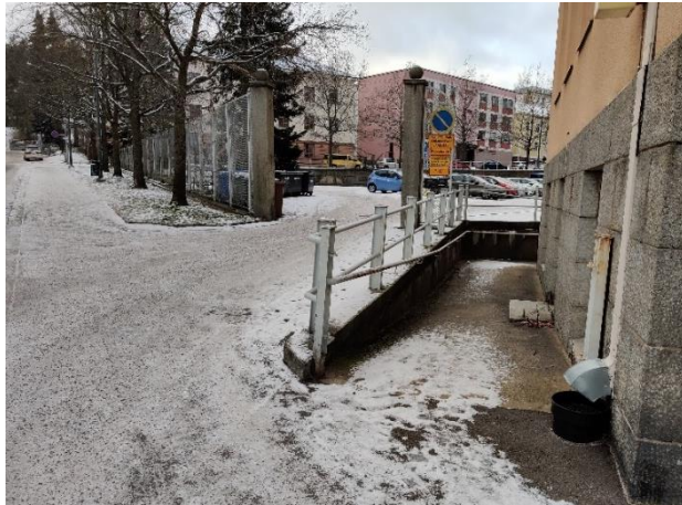
Kuva 33. Koulun piha-alueelle johtava kookas pääportti. Vasemmalla näkyy Lyseonkadun puoleisella sivulla muurin päällä sijaitseva verkkoaita ja oikealla seinän vierustan luiska. (kuva T.T.)
