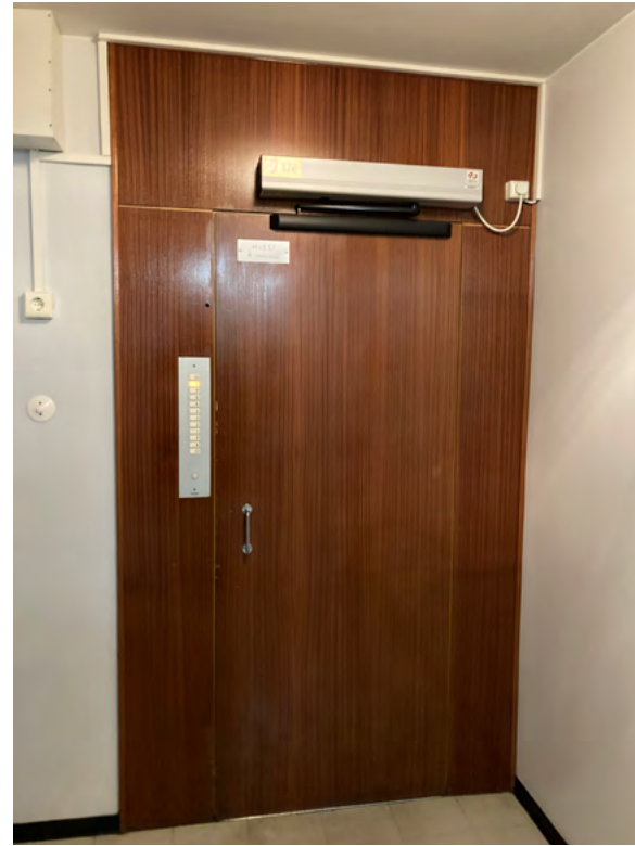
Yllä: Osaan hissien ovista on lisätty automaattisia oven avausjärjestelmiä.
