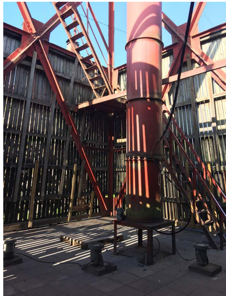
Vuonna 1995 rakennetun hauliputken alimmat teräslieriöt ja teline. Lattiataso betonilaatoitettiin (saastuneen maaperän eristys-rakenne) vuonna 2016 (Piirtola & Lindroos 2017, 5). Laatoituksen päällä näkyy useampia kohdevalaisimia.
