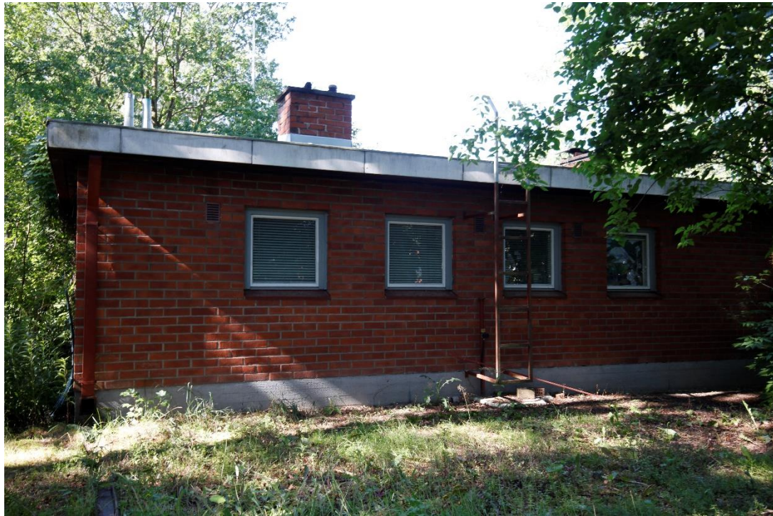
Kuva 33. Uusi asuinrakennus. Ikkunoiden neliskanttinen muoto ei vasta lupapiirustuksessa esitettyä. Todennäköisesti kyseessä on työmaa-aikainen muutos.
