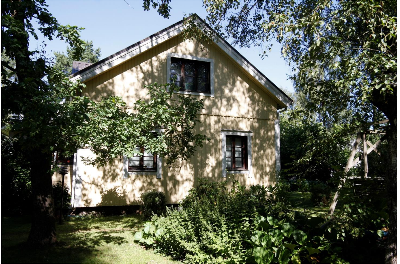
Kuva 18. Vanha päärakennus, pääty. Pystysuuntainen laudoitus, jonka rytmi muuttuu yläkerrassa. Ikkunoiden koriste-laudoitus on muutettu peruskorjauksen yhteydessä (1982). Lisäeristyksen takia ikkunat ovat syvällä seinän pintaa nähden.
