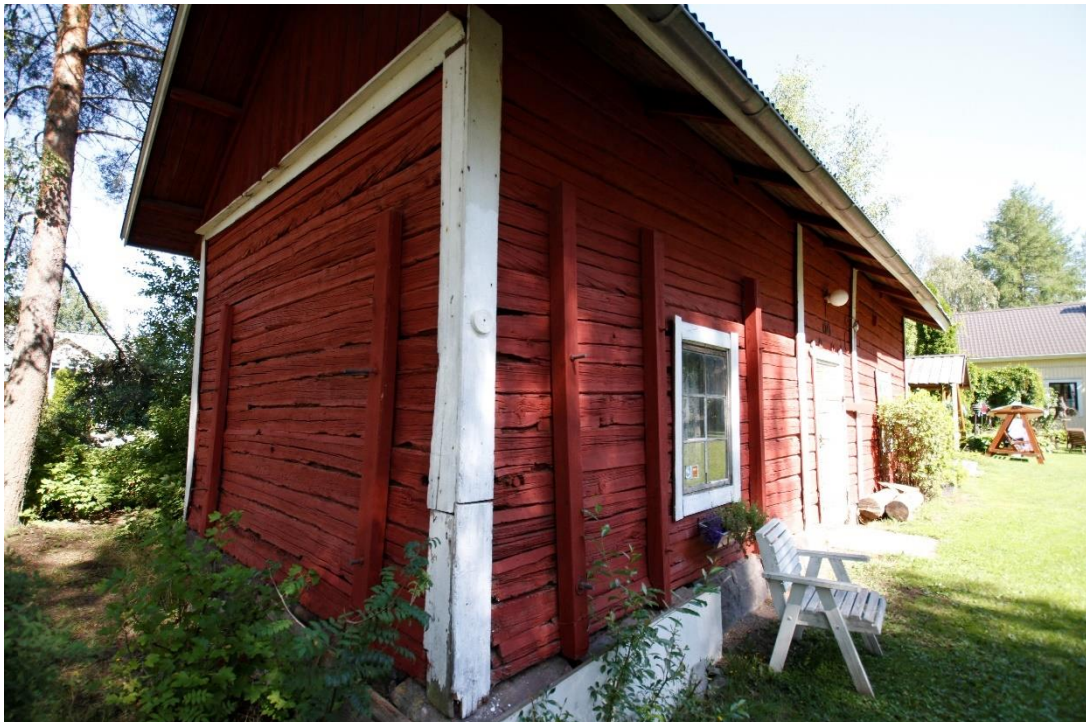
Kuva 26. Karjakeittiö / vanha sauna. Hirsirakenne on huonokuntoinen. Följarit ovat myöhempää tekoa, uutta sahatava- raa.
