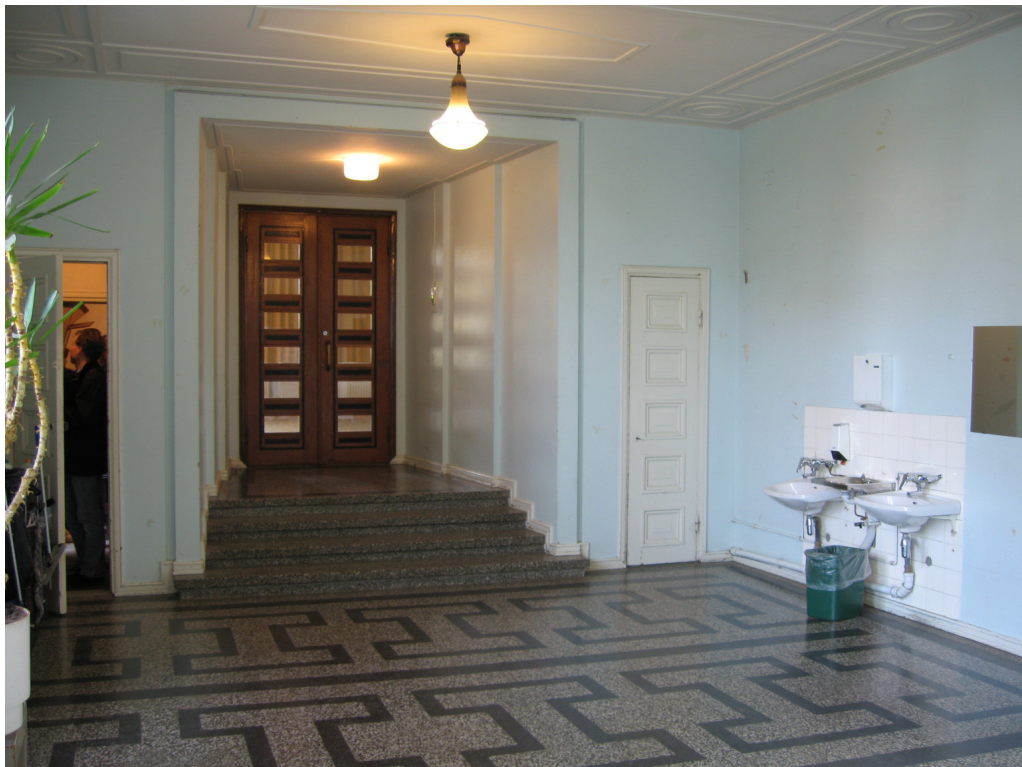
Kuva: Aula. Nykytilanne. Seinä- ja kattopintojen väritys poikkeaa alkuperäisestä.
