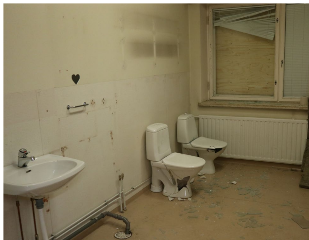
Paikkoja on rikottu mielivaltaisesti. Lasien ja vesikalusteiden rikkominen rajoittuu lähinnä Ilmarinkadun puolen kellarin ja 1. kerrokseen. Vedet on katkaistu.
