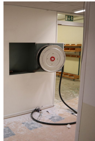
Palosammuttimia on tyhjennetty. Lisäksi liiketunnistimet on rikottu Ilmarinkadun puolelta.
