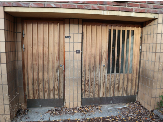
Etelään suuntautuvat ovet läntisen Saukonpuiston puolen pihanpuoleisella julkisivulla ovat pintakäsittelyn tarpeessa. Nämä ovat kaikista ovista huonoimmassa kunnossa, mutta silti vain pintakäsittelyn tarpeessa.
