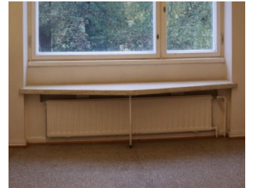
Ikkunoissa on mosaiikkibetonikkunalaudat ja joidenkin ikkunoiden edessä on kiinteä pöytä. Parvekkeet ovat huonosuunnassa.
