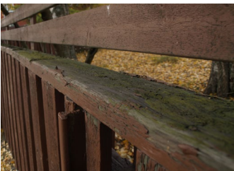
Tontin aidat ovat pääosin ehjiä maalipintaa lukuunottamatta.
