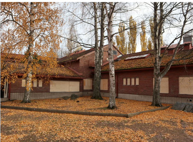
Jokunen ikkuna on rikottu. Suurin osa on levytetty ehjinä.
