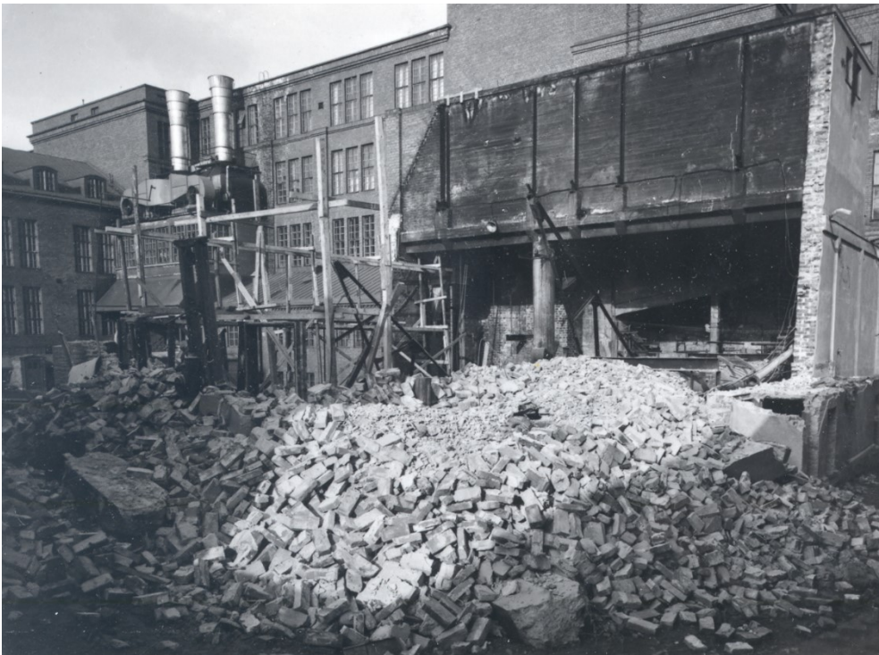
Vanhan kattilahuoneen purkaminen vuonna 1952. Kattilahuoneen tilalle valmistui myöhemmin 1950-luvulla tehdassali. Vanhan kattilahuoneen paikalla olevaa sähkökeskusta kutsutaan kattilapirtiksi. Kuva: Staf/Serlachius-museon kuva-arkisto.
