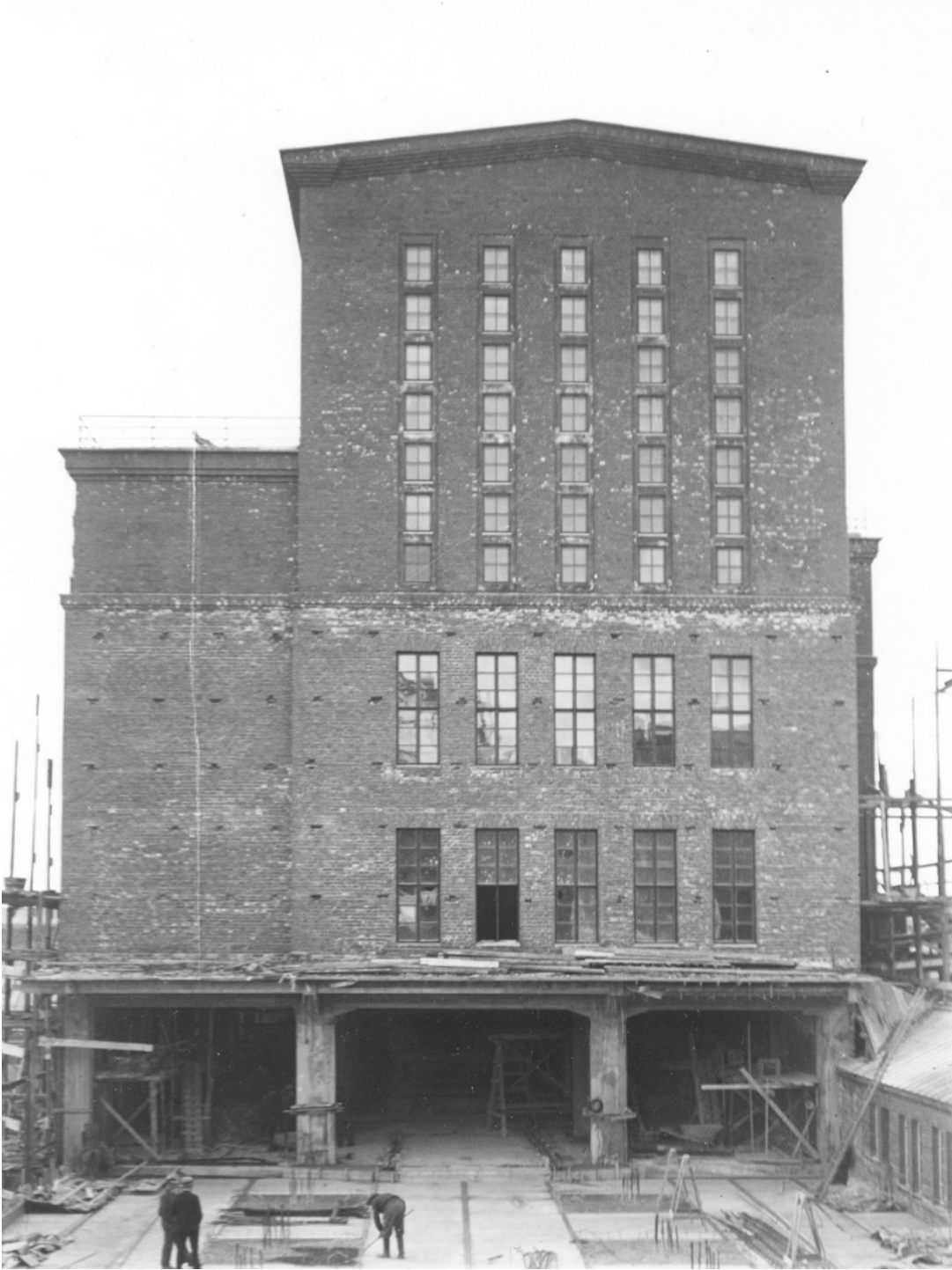
Takon tehtaiden laajennustyö käynnissä vuonna 1934. Kuvassa näkyvät kannattelevat rakenteet eli betonipilarit. Kuva: Warner Silfversparre/ Gösta Serlachiuksen taidesäitiö, Serlachius-museot, kuvakokoelmat.
