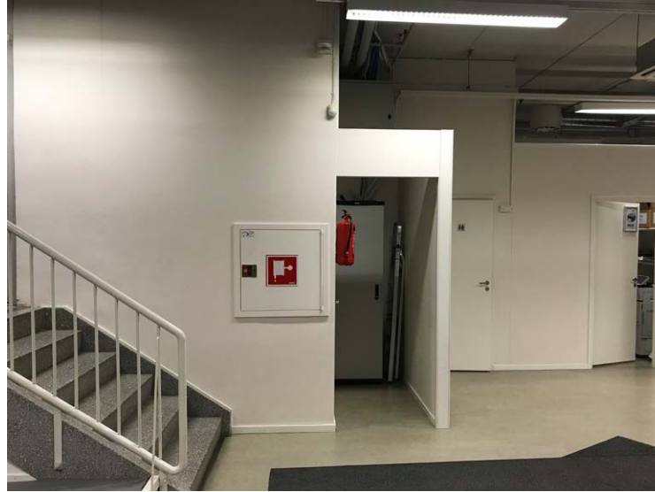
Liikerakennuksen sisätiloissa on tehty muutoksia vuosien varrella: kuvassa paloturvallisuusvälineistöä.
