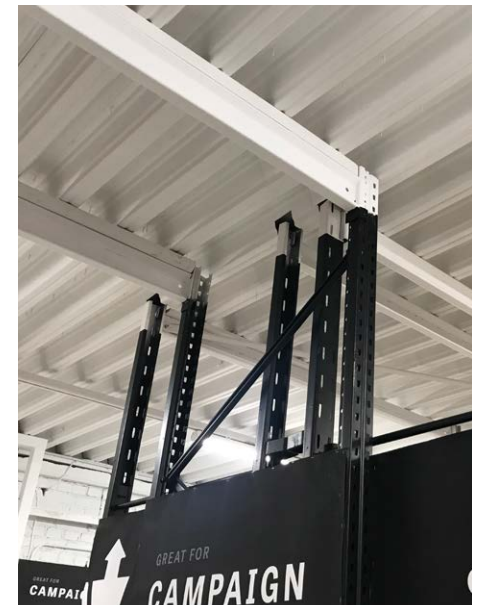
Hylljärjestelmä on teräskattorakenteen kanssa yhtä.
