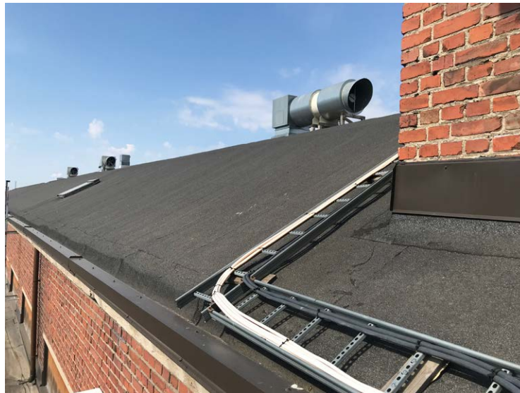
Takan vanhan varastorakennuksen huopakatolla on uutta teknologiaa. Kuvassa sähköjohtokiskoja ja ilmastointilaitteita.
