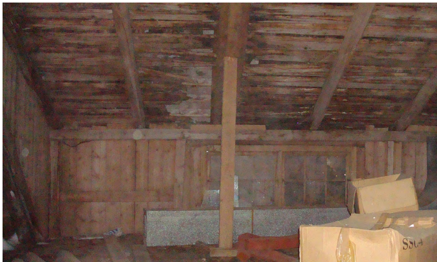
Vesikaton aluslaudoituksen kosteusvaurioita. Laudoituksen raoista näkyy vanhoja päreitä.
