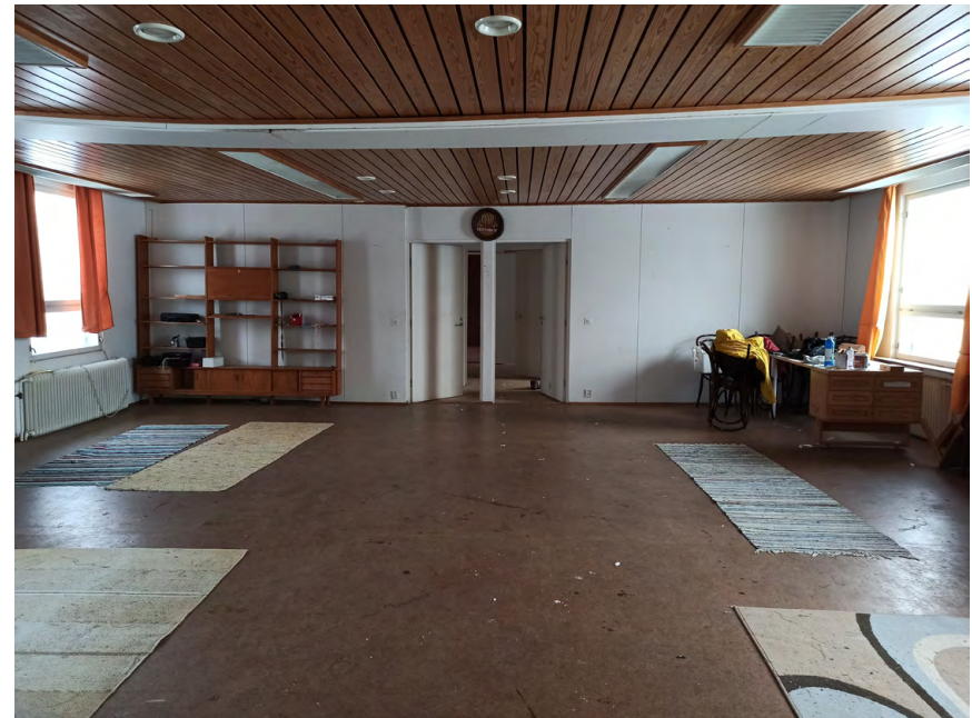
Rakennuksen keskeltä on purettu poikittainen hirsiseinä. Katto on notkahtanut ja lattiat viettävät.
