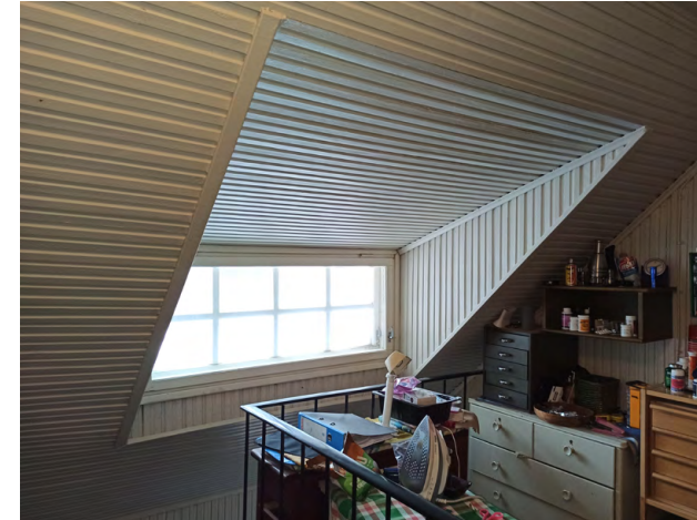
Portaikun kattoikkuna vaikuttaa olevan paremmassa kunnossa kuin koillispuolella.
