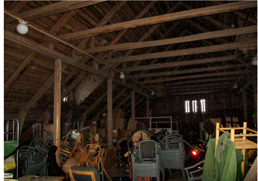
Navetan toisen kerroksen kaakkoispäätä. Kantavat hirsirakenteet näyttävät pääosin hyväkuntoisilta.
