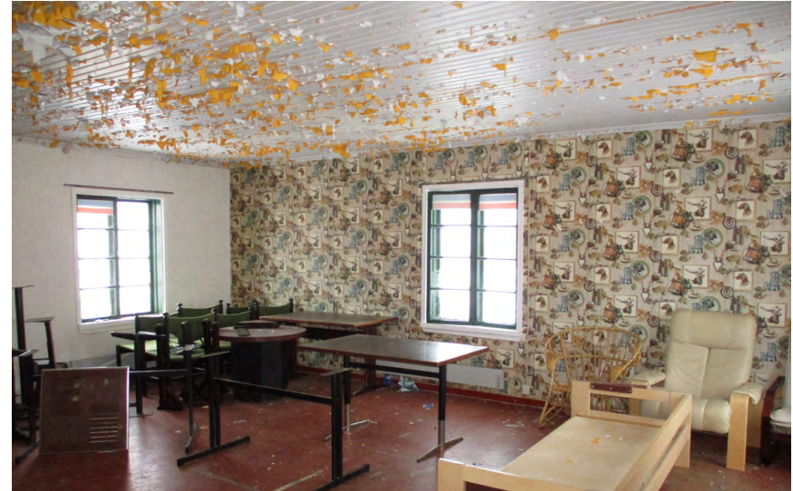
Luoteispään kamarin lattia on maalattua kovalevyä. Katon maalityypin valinta ei ole onnistunut optimaalisesti.
