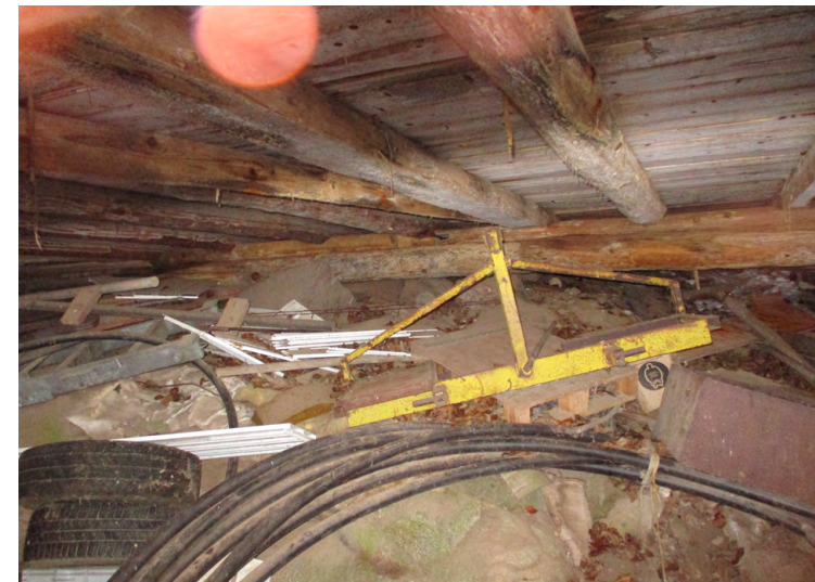
Alapohjan tuuletavuus on osin estynyt tuuletustilaan jätetyn tavaran vuoksi.
