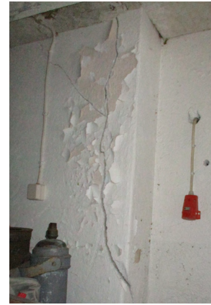
1. kerroksen halkeillutta seinää.
