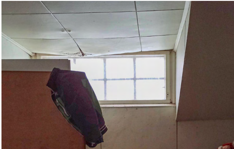
Asunnon eteistilan kattolyhdyn kosteusvaurio näkyy selvästi katon kuitulevytyksessä.
