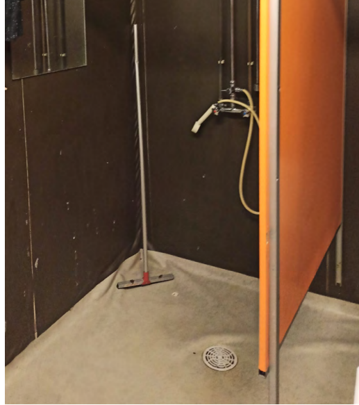
Kylpyhuoneen muovimatto ja seinäpinnoite ovat irti pohjasta. Värimaailma vastaa alakerran wc-tiloja.
