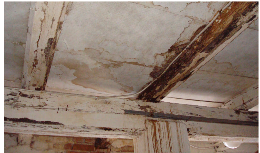
Ensimmäisen kerroksen katon kosteusvaurioita.
