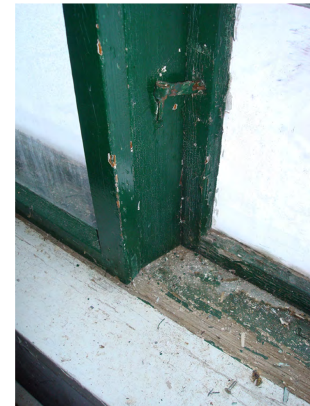
Ikkunoiden maalipinnat kaipaavat kunnostusta.
