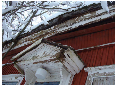
Kaakkoispuolen sisäänkäynnin kohdalla räystääs on rikkoutunut. Sisäänkäyntikatosten frontonit ovat aikoinaan olleet huolella tehtyjä.
