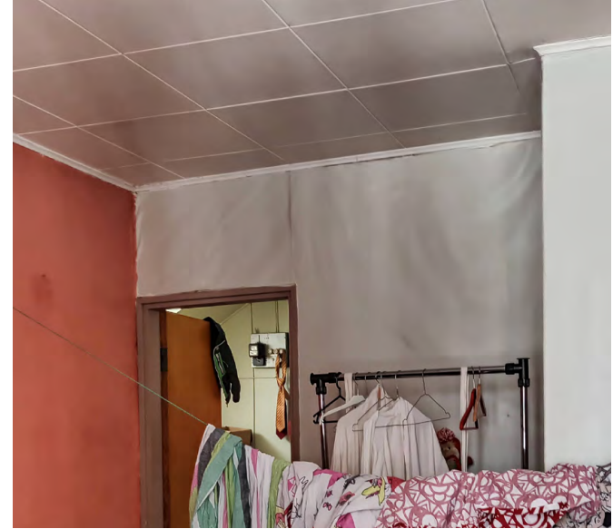
Keittiön yläpuolisen asunnon katto on huokoista kuitulevyä. Seinien pinkopahvit ovat löystyneet.
