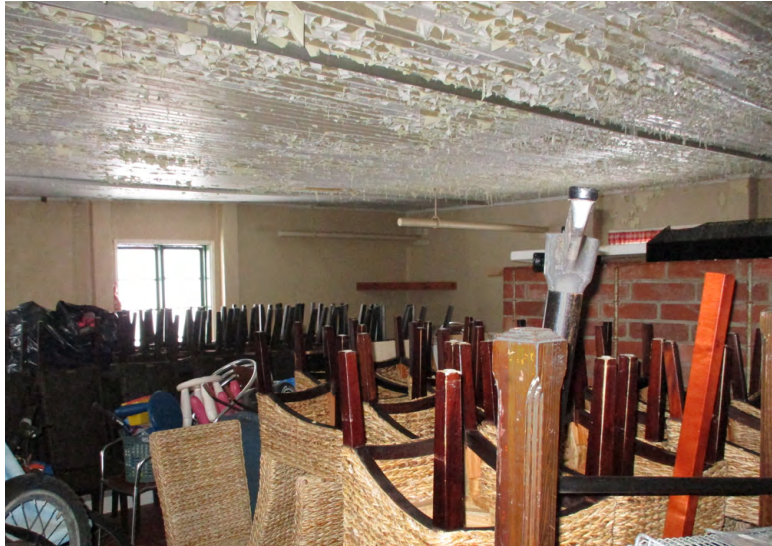
Pakaritupa on täynnä kesäravintolan kalusteita. Maali irtoilee liuskoina paneelikatosta.
