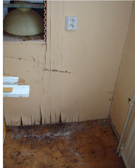
Kosteusvaurio keittiön ja olohuoneen välisessä seinässä.
