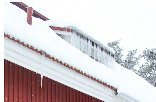
Kattolyhdyn kohdalta karkaavan lämmön paljastava jääpuikkorivi.
