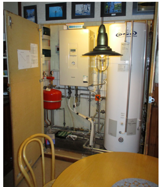
Lämminvesivaraaja ja lämmitysjärjestelmä taukotilan komerossa.
