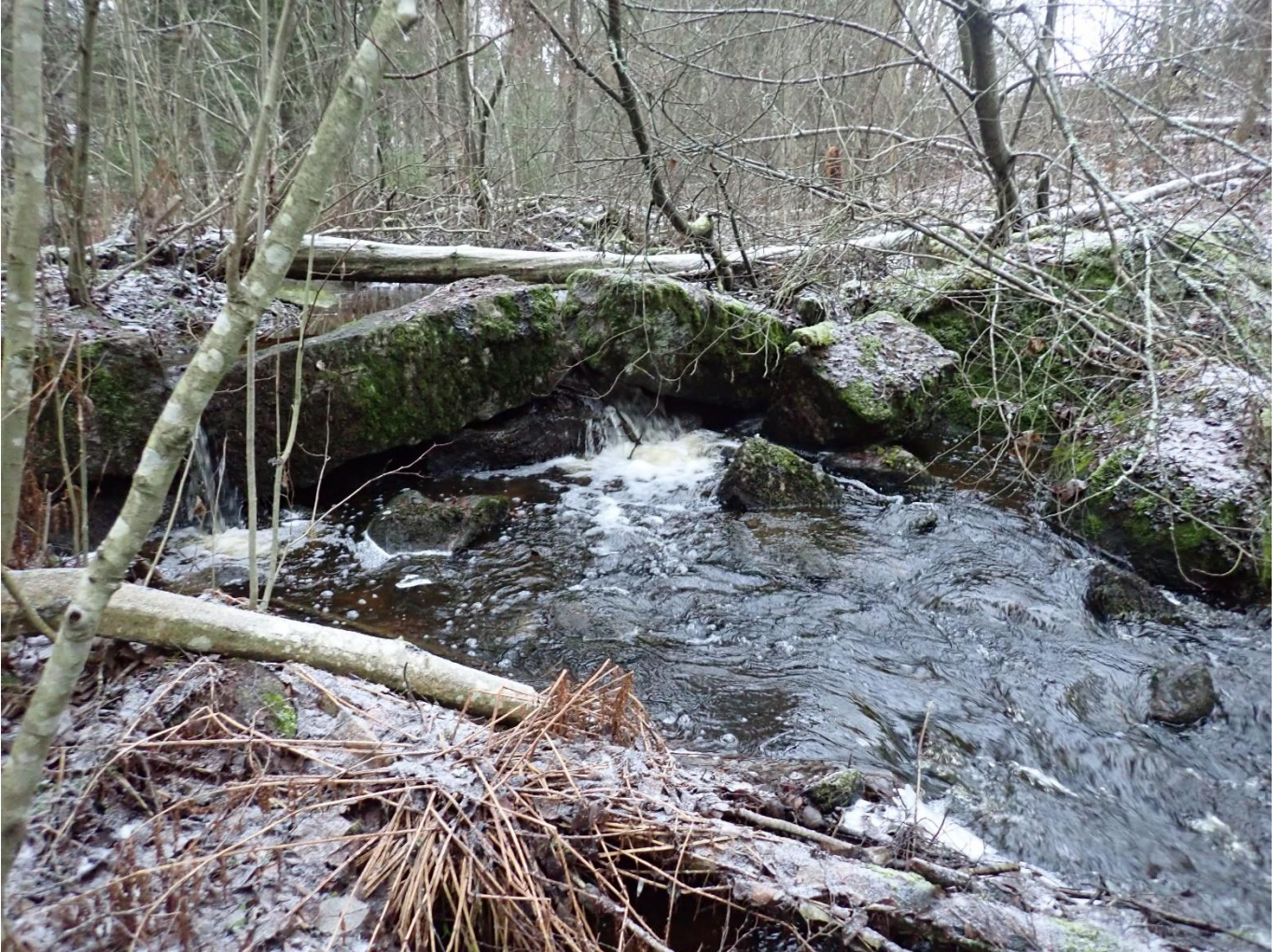
Kuva 6. Kynniojan kivrakenteen itäpäässä on isohko maakivi. Lohkokivet ovat liikkuneet paikoiltaan.
