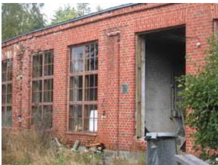
Kuva 24. Veturitalli on päässyt huonoon kuntoon. Kuvattu syksyllä 2005. (Kuvan 27 kohde 5).
