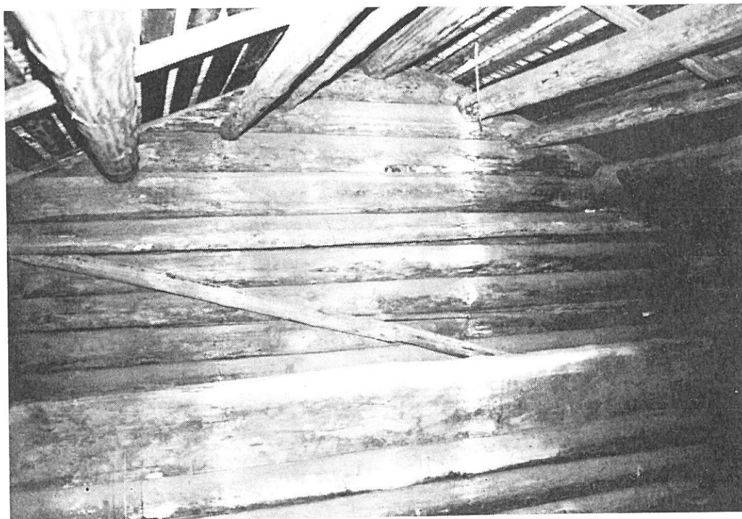
Yläkerta sisältäpäin kuvattuna. Valoaukko keskellä kuvaa. Tulenpidon merkit näkyvät mustuneina seinähirsinä.
