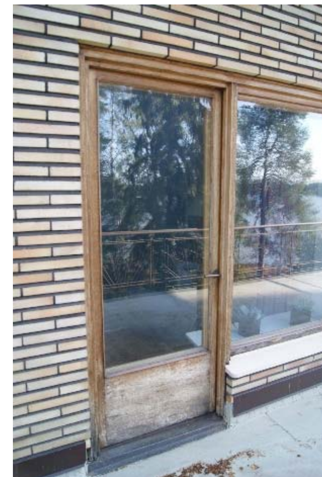
Kuva 106 – Toisen kerroksen Halli tilan parvekkeen ulko-ovi – ovi aukeaa sisäänpäin. Ikkunan ja oven yksityiskohdat on tehty samalla pieteetillä, kuin ensimmäisen kerroksen edustustilojen ikkunoiden ja ovien yksityiskohdat. Tammipinnoissa on ajanpatinaa.
