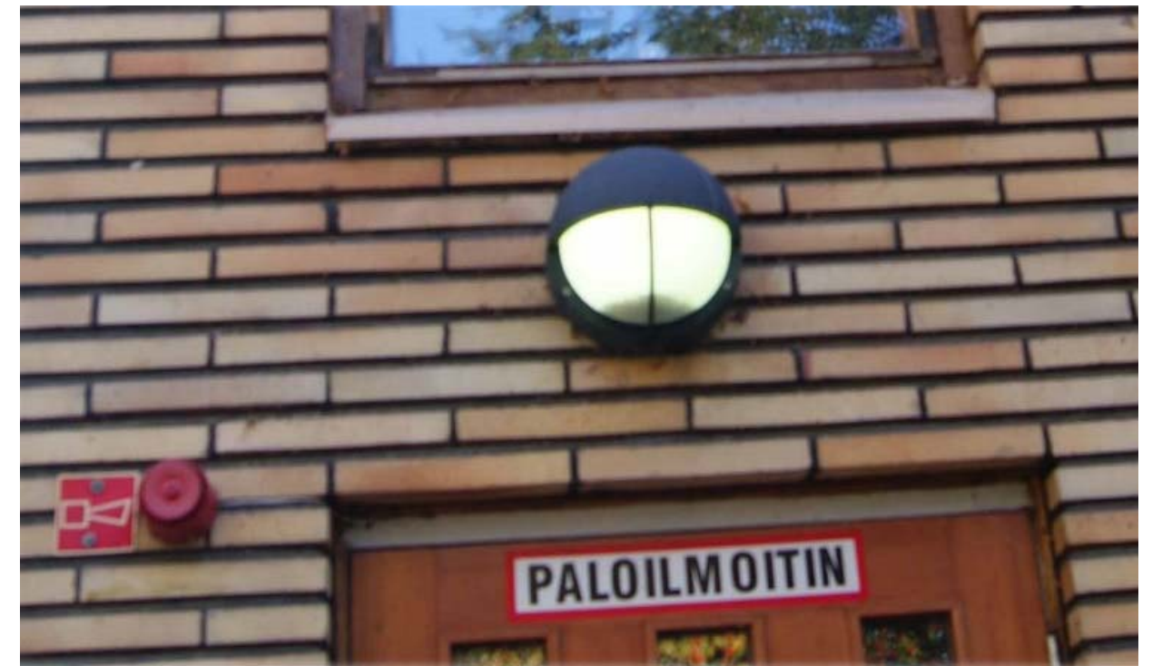
Kuva 130 – Keittiön huollon valaisintyyppiä on asennettu myös porrashuoneen parvekkeen ulko-oven yhteyteen ja keittiön huoltapuolen julkisivulle.
