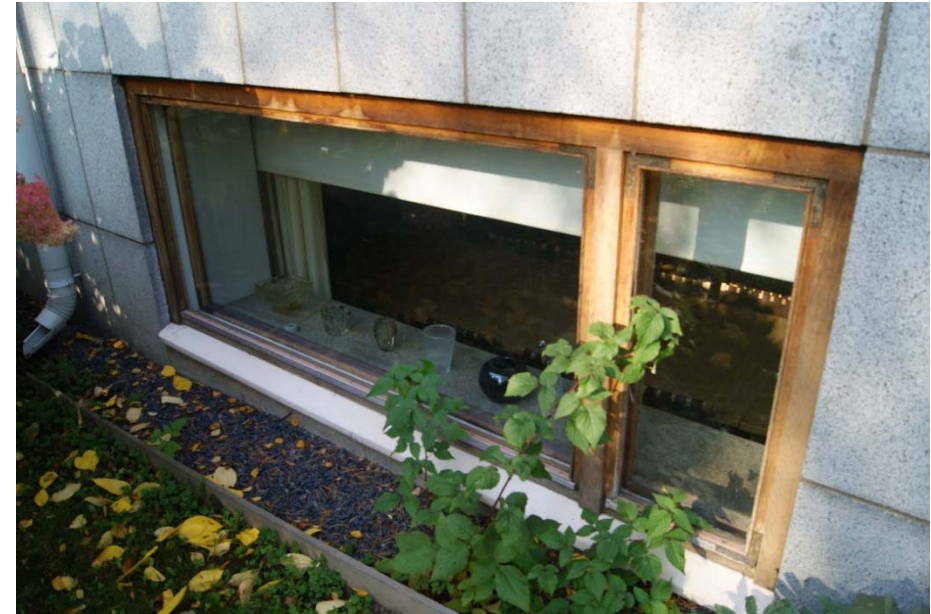
Kuva 94 – Kellarikerroksen ikkunat on tehty suurelta osin siten että: ulkopoka ja karmien ulkoreuna ovat tammaa ja muu osa karmia polttomaalattu. Kuvan ikkunan ulkopoka ja karmien ulkoreuna on tammaa, sisäpoka on valikoitua mäntyä, karmi peittomaalattu.
