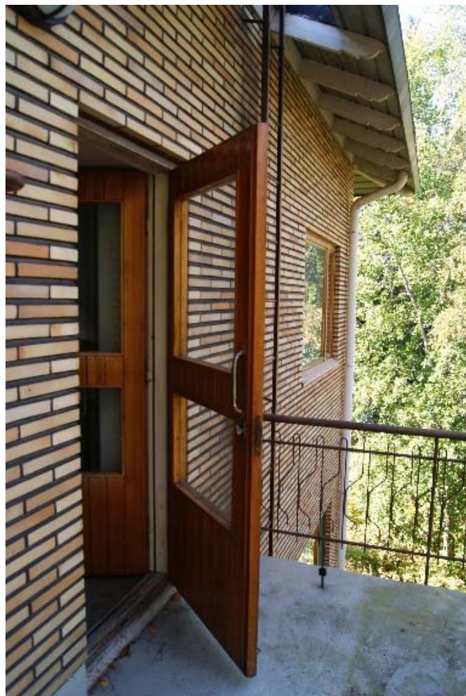
Kuva 108 – Porrashuoneen parvekkeen ulko-ovi. Parvekkeen lattiataso on tehty pinnoitetusta betonista lattiakallistuksella, joka viettävät ulkoseinästä ulospäin.
