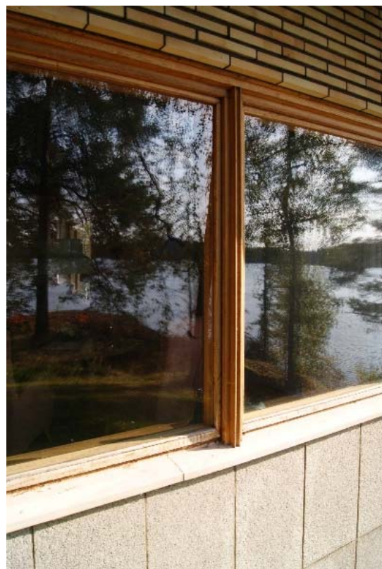
Kuva 97 – Tärkeimpien huonetilojen ikkunoiden karmit on tehty muotoillen tammesta – katso detaljipiirrosta ikkunoista edellä.
