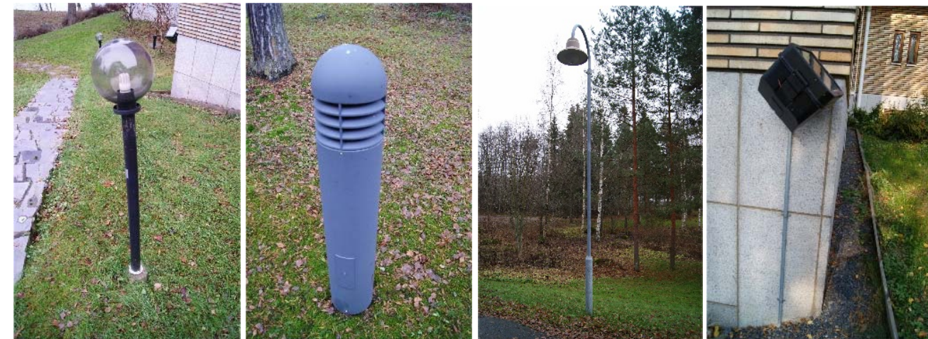
Kuva 16 – Pihalla olevia valaisimia, pihalla on useita erilaisia valaisimia (uudehkoja), joita on lisätty tarpeiden mukaisesti, kuvissa on esitetty muutamia. Vasemmalta oikealle – puistovalaisin, saunalle johtavan liuskekivikäytävän varrella – pylväsvalaisin, pääsisäänkäynnin yhteydessä etukumpareen reuna-alueilla – pylväsvalaisin, autopaikoituksen ja tien ympärillä oleva valaisin – pihavalaisin, jolla valaistaan rakennusta ja rakennuksen läheisyydessä olevia kohteita – valaisimien asennusvuosista ei ole tietoa, mutta kaikki pihan valaisimet ovat suhteellisen uusia, alle kaksikymmentä vuotta vanhoja
