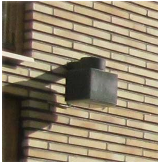
Kuva 131 – Keittiöportaan ulko-oven läheisyyteen asennettu valaisin – asennusvuosi 1970-luvun alkupuoli.
