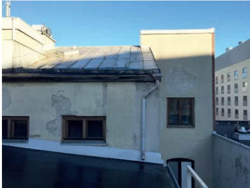
Julkisivuvaurioita sisäpihan puolella. Kattopinta on myös varsin kulunut.
