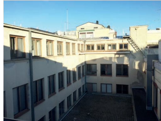
Sisäpihan julkisivuissa näkyy laajalti vaurioita ja jo tehtyjä paikkauspaikkoja.
