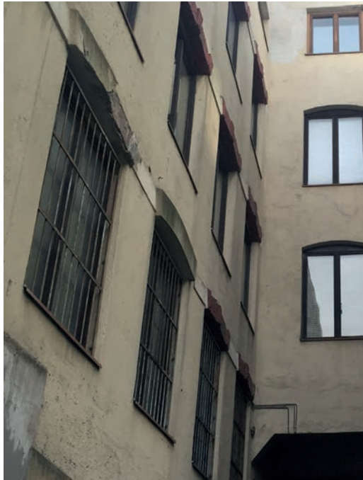
Julkisivuvaurioita vanhimmassa osassa.
