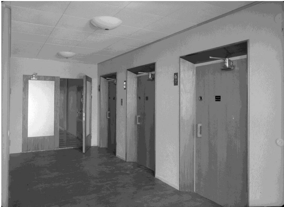
Kuva 45. Amurinlinnan pilvenpiirtäjän 3 hissiä, joihin kuhunkin mahtuu 10 henkeä, hoitaa henkilöliikennettä eri kerrosten välillä. Ne ovat valitsevia ja kokoavia hissejä, jotka pysähtyvät myös matkan varrelta ottamaan lisää kuljetettavia. Tällaisia hissejä ei tähän asti ole ollut Tampereella eikä koko maassa. Hissien ohella on kaksi porraskäytävää, joista toinen on varaporras. Veikko Kanninen 6.9.1955. Vapriikin valokuva-arkisto D/341 Finlayson alb8:245.
