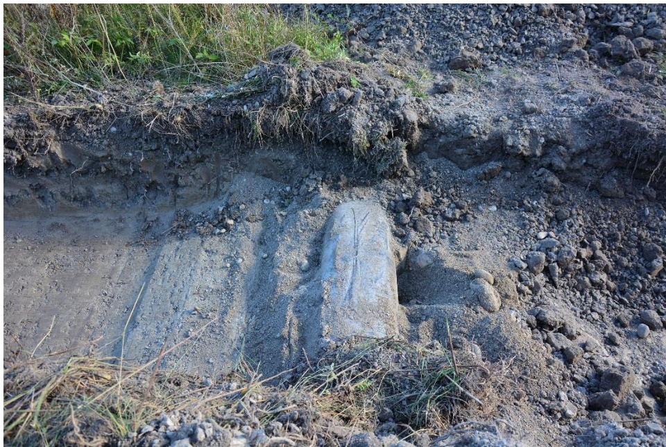
KYY300:26 Tampere, Pappinen. Koeoja 1, moderni lämpöputki. Kuva: Ulla Moilanen
