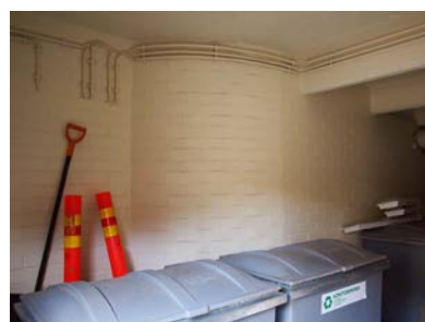
Entisen tallirakennuksen sisäpuolella näkyy vanha rakenteita, kuten tiiliseinää ja palkkeja. Katossa on jälkiä betonin valussa käytetystä muostista.
