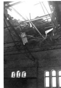
Pommin tekemiä tuhoja Pakkahuoneen katoissa. (Kuva: Bertel Strömmer, Tampereen museot)
