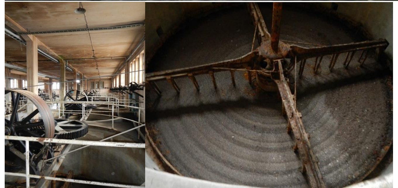
R1. Vasemmalla ylhäällä sisäänkäynti ja poikkipääty, johon on sijoitettu henkilökunnan tilat, oikealla eteläpään ovi, alakuvassa neljän ikkunan ryhmä, niiden alla alumiinisulfaatin purkauspaikka ja sen johdosta tuhoutunutta tiiliseinää. Oikeanpuoleisissa kuvissa rakennuksen keskikäytävä ja sen molemmin vedenpuhdistusaltaita puhdistuslaitteineen.
